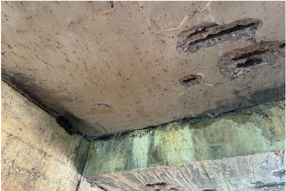
Abb. 5: Betonschäden am Unterbau
