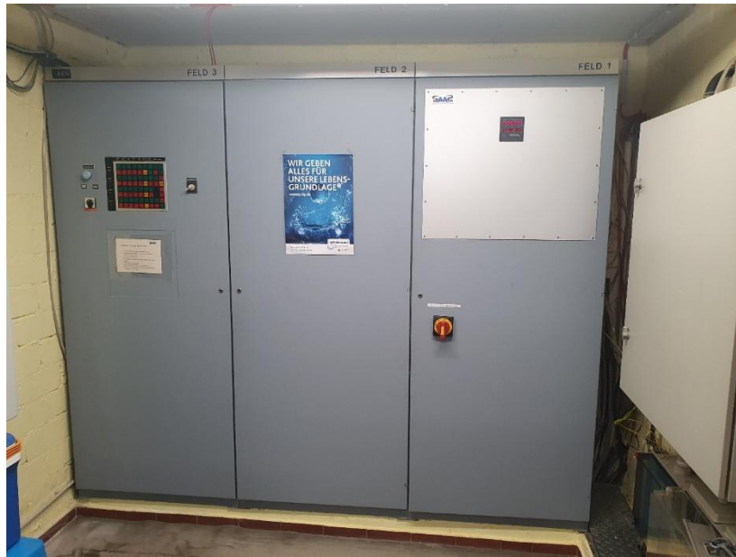
Abbildung 16: Niederspannungsverteilung Feld 1 bis 3 Außenansicht
