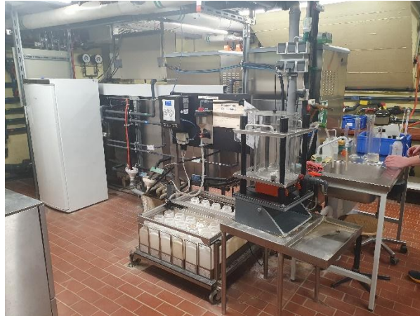
Abbildung 7: Probennehmer und Leitungssystem (UG)
