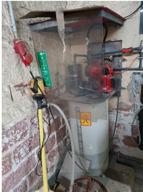
Abbildung 12: H2O2 Dosierstation (BR)
