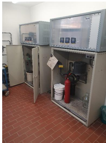
Abbildung 5: Kontinuierliche Messtechnik mit Durchflussmesstöpfen (EG)
