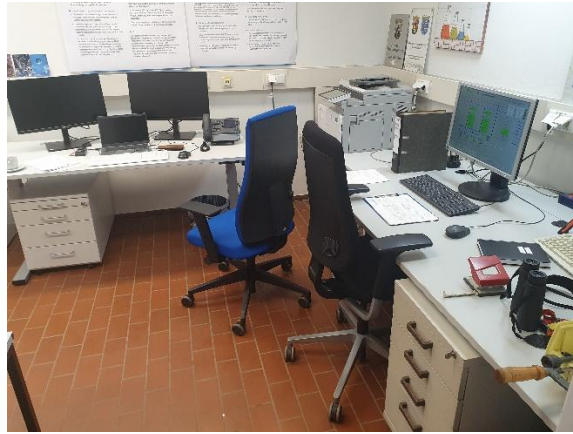
Abbildung 4: Büro- und Serverraum mit dem PLS-Server (EG)
