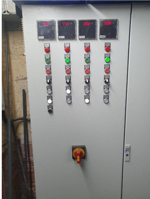
Abbildung 27: FU-Schrank zur Regelung und Steuerung der vier Messwasserpumpen
