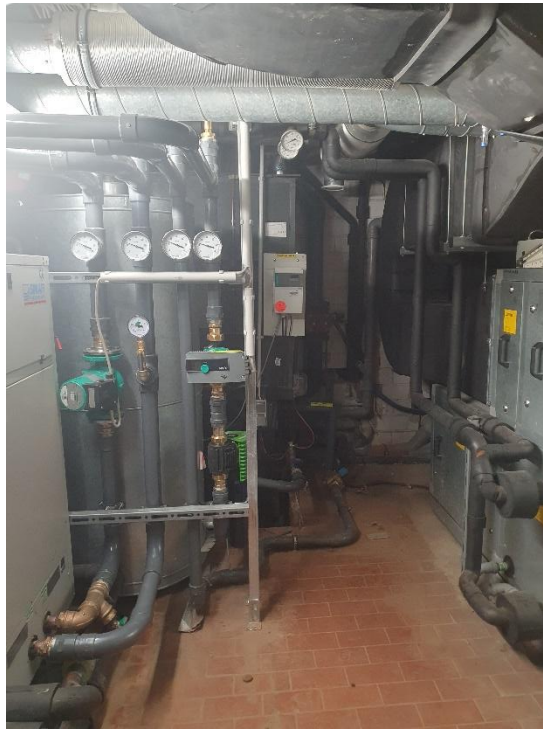
Abbildung 10: Technikraum mit Brunnenwasser-Vorratsbehälter (UG)
