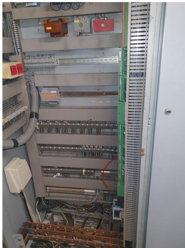
Abbildung 17: Feld 3 Innenansicht mit Interbus Komponenten der E/A-Unterstation 1 (Siehe rechter Rand)
