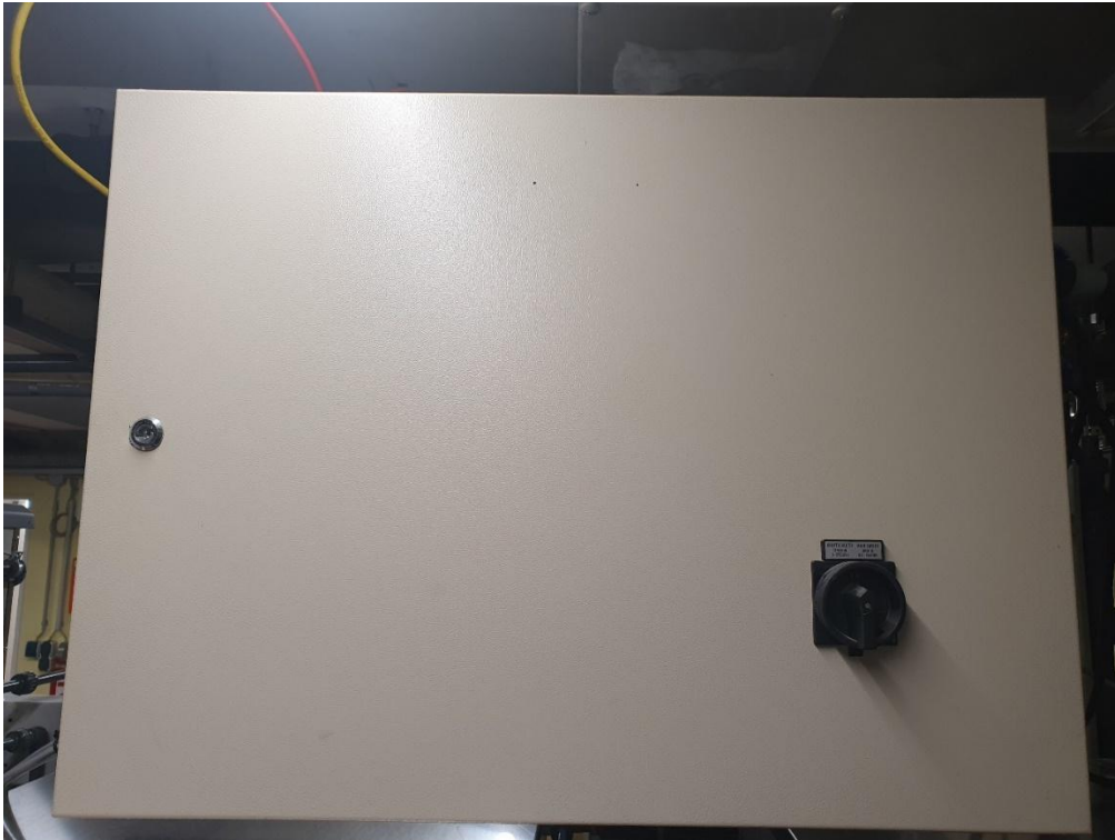
Abbildung 19: Verteilerkasten EA-Unterstation 2 Außenansicht
