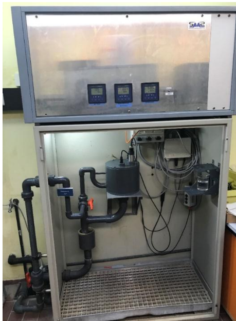
Abbildung 30: Einer von zwei Messschränken für die kontinuierlichen physikalischen Messungen im Erdgeschoß der RUST. In den Messtöpfen befinden sich die Sensoren für Sauerstoff, Leitfähigkeit, Temperatur und pH-Wert.
