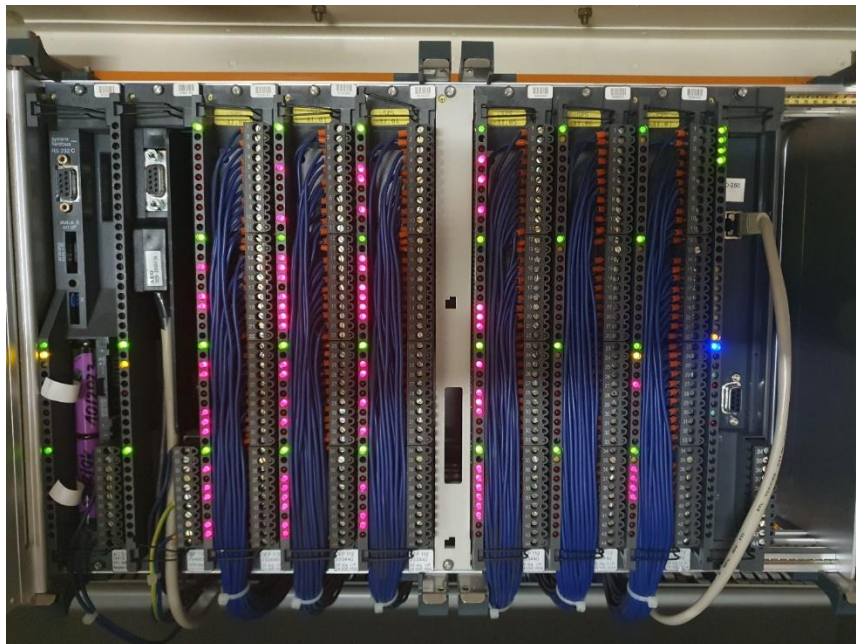
Abbildung 18: Ansicht der I/O Baugruppen (BG) auf BGT 1 mit der AEG Modicon A250 (BG 1), Feldbus Koppler (BG2) und der APEX PAD250 (BG 9)
