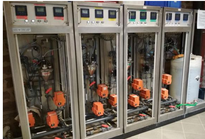
Abbildung 27: Kontinuierliche Messeinrichtungen mit den vier Einzelmessungen und Spülbehälter im Stahlgehäuse (Spülbehälter weiß und rechts hinten)
