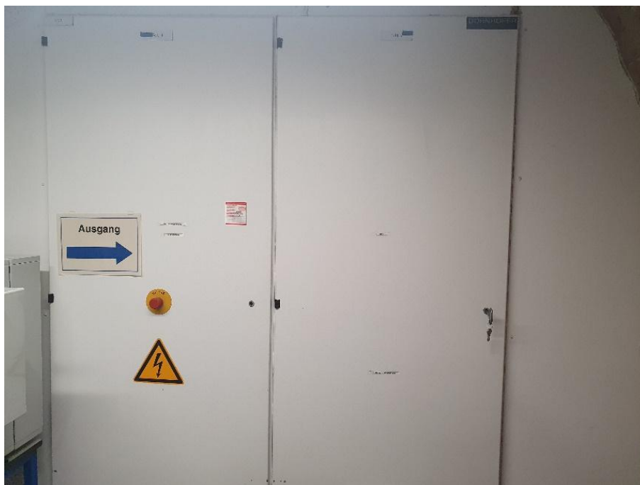
Abbildung 16: Außenansicht SPS-Schrank UV1 Feld 2 (siehe rechter Schaltschrank)
