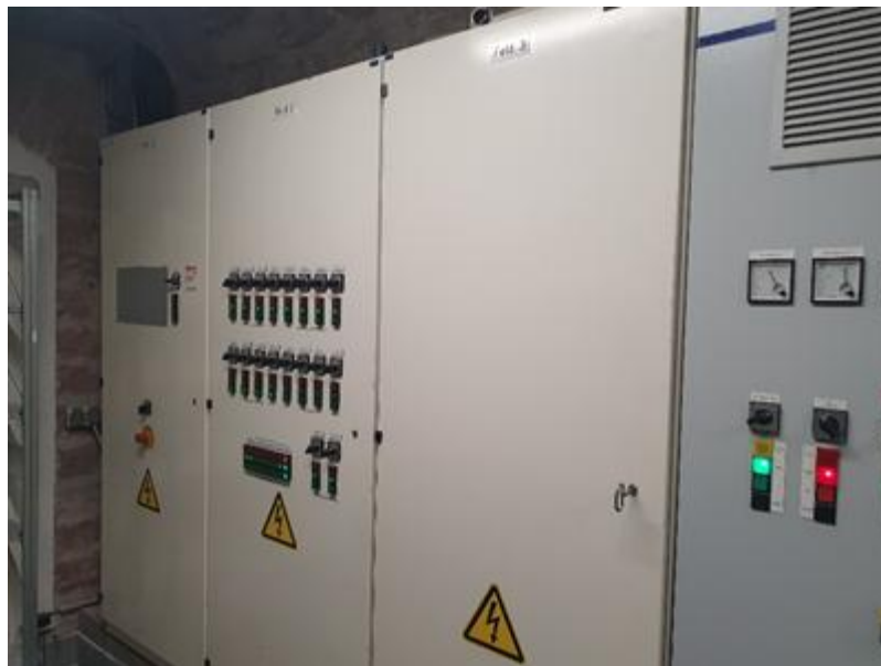
Abbildung 13: 2. OG Altbau, Schaltschränke UV2 Feld 1 bis Feld 4 inkl. SPS-Schrank (Feld 3)
