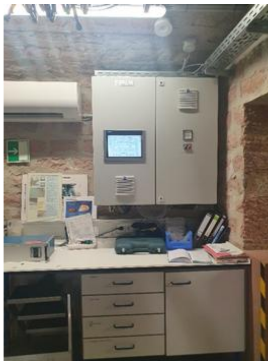
Abbildung 7: 1. OG Altbau, NS-Verteilung Mischwasseranlage
