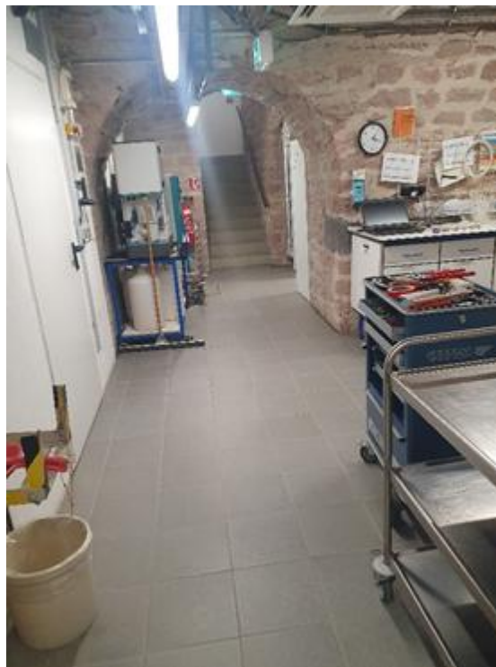
Abbildung 9: 1. OG Altbau, Gang zum 2. OG Altbau mit SPS-Schrank (Siehe links)
