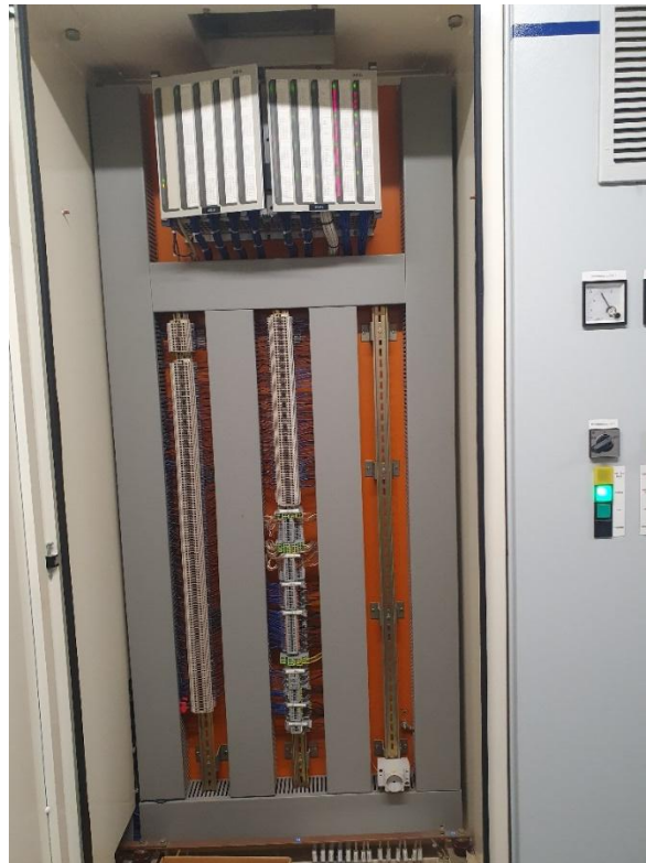
Abbildung 21: Innenansicht SPS-Schrank UV 2 Feld 3 mit SPS-Hardware (BGT1)
