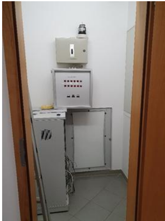
Abbildung 5: 1. OG Neubau, Raum mit Serrack (siehe links)
