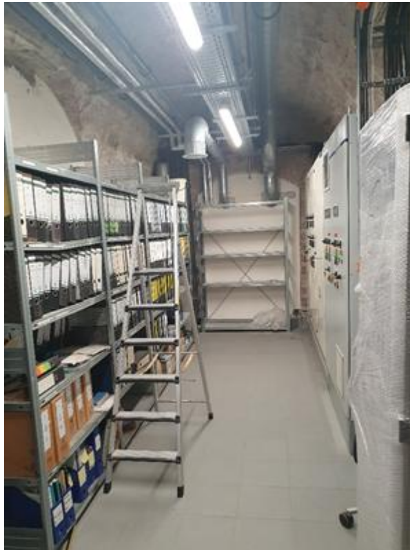
Abbildung 12: 2. OG Altbau, Gang mit Schaltschränken (siehe rechts)
