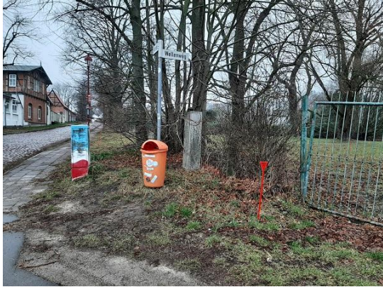
Roter Markierstab: Ansatzpunkt BS 10/25, Ausbau zum Grundwasserpegel RFP 1/25 (Foto: Inros Lackner SE, 05.02.2025)
