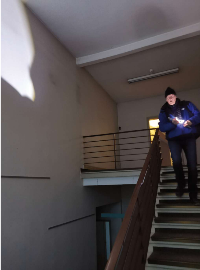
Zu verstärkender Unterzug 2 Treppenhaus West
