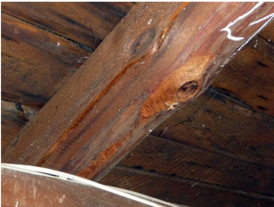
Bild 16: Deutliche Rissbildung an der Flanke von Sparren 21;
