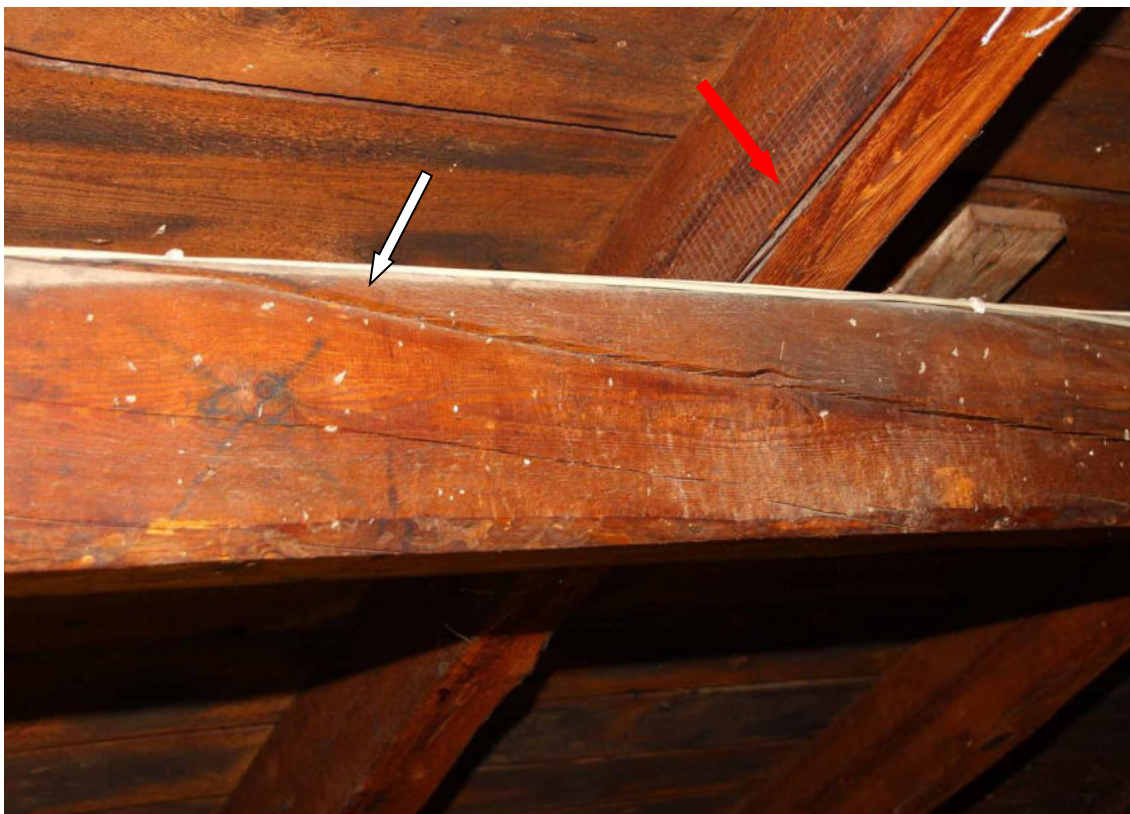
Bild 15: Diagonalriss in Sparren 19 ausgehend von der Kante (roter Pfeil) und Riss in der Mittelpfette (weißer Pfeil), der in einen Bruch (Durchbiegung nach oben) übergeht;
