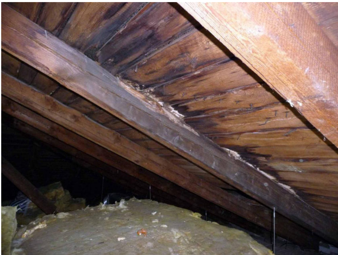
Bild 17: Sparren 85 mit einer Totalzerstörung durch den „Weißer Porenschwamm“;
