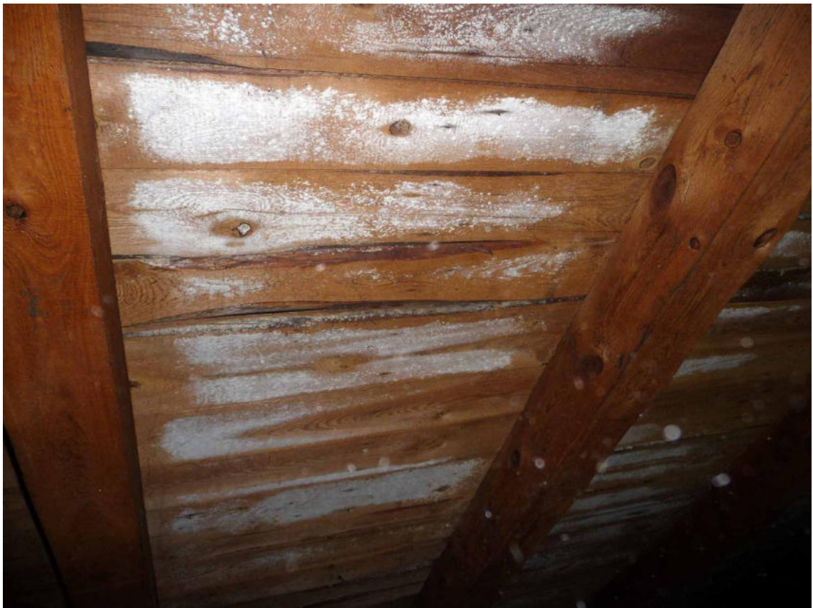
Bild 9: Schimmelpilzbefall an der Dachschalung im nordseitigen Anbau;
