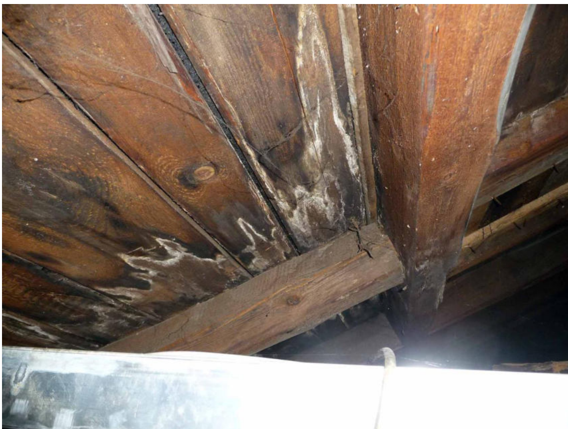
Bild 6: Alter Nassfäuleschaden an der Dachschalung unterhalb eines Schornsteinwechsels;
