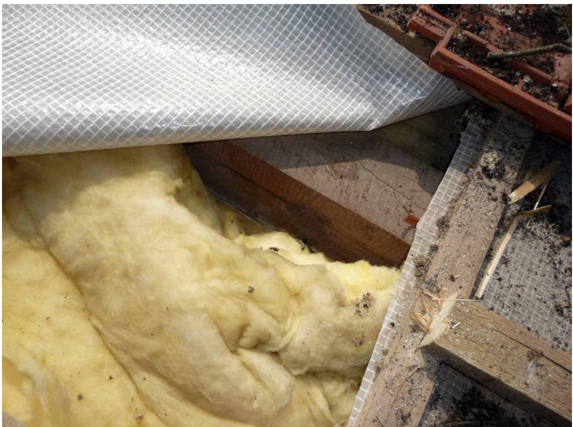
Bild 22: Dachöffnung an der Westseite des südseitigen Anbaus mit intaktem Sparren;
