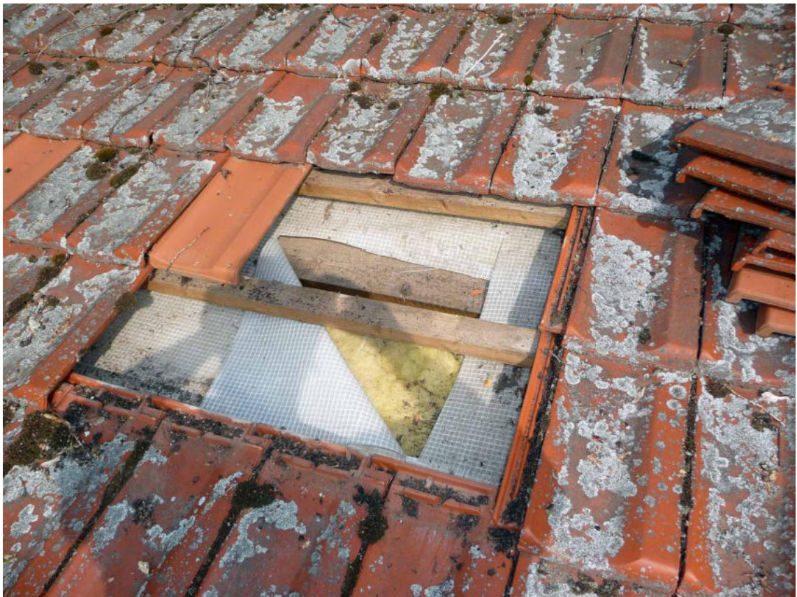
Bild 23: Dachöffnung an der Ostseite des südseitigen Anbaus mit intaktem Sparren;
