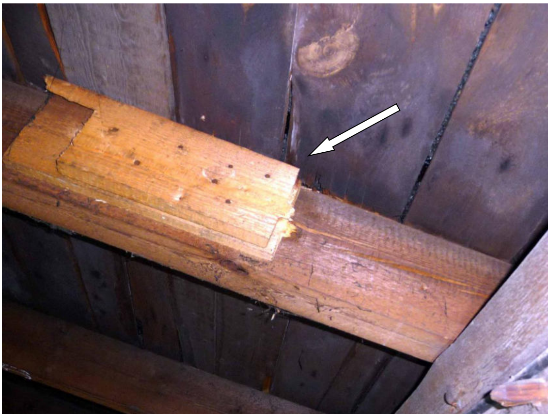
Bild 5: Nassfäulegeschädigte Dachschalung, die nicht saniert worden ist, sondern nur durch angenagelte Brettstücken unterstützt wurde;
