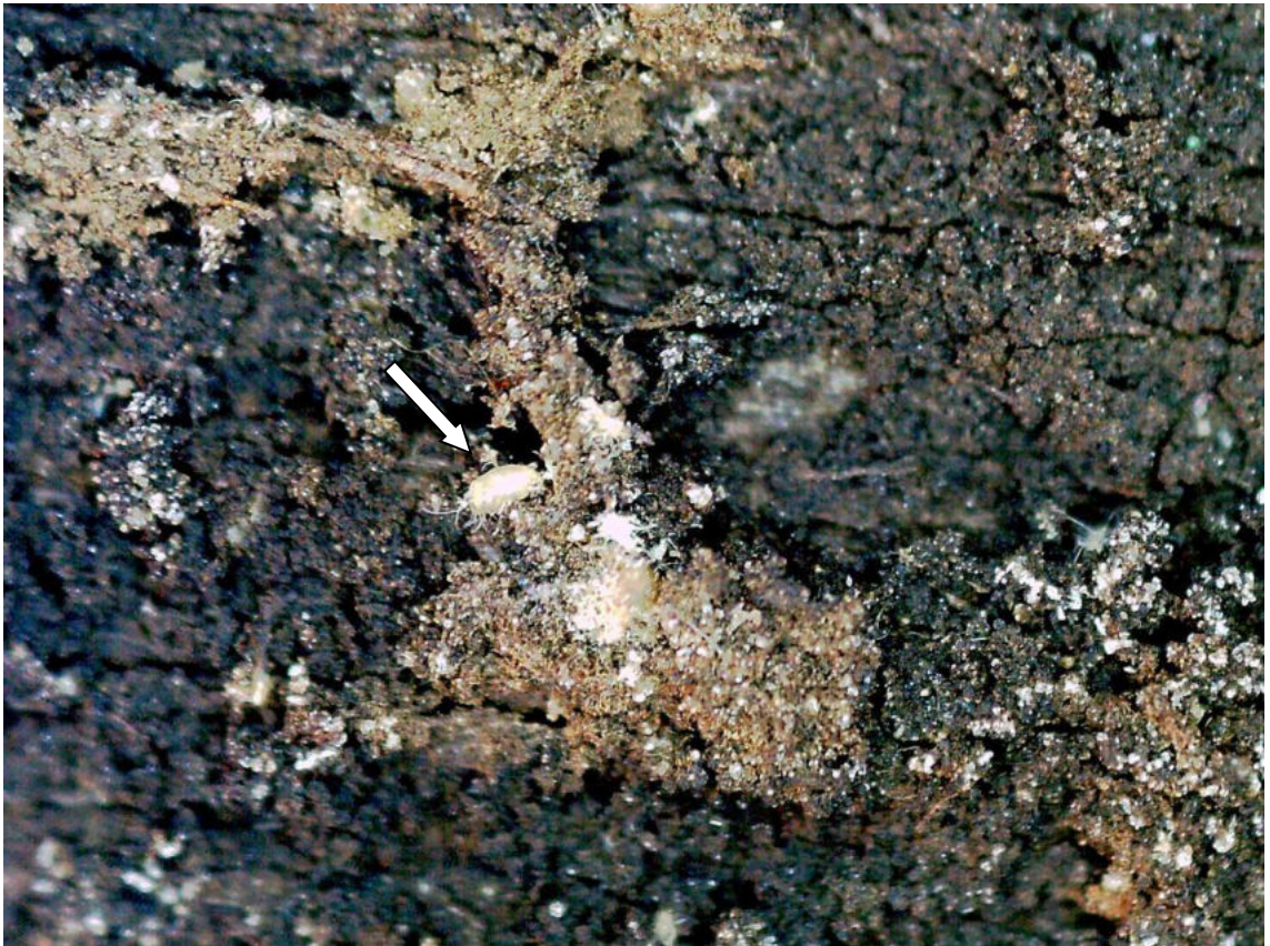
Bild 13: Lebende Milbe im Substrat an der Unterseite der Dachschalung;
