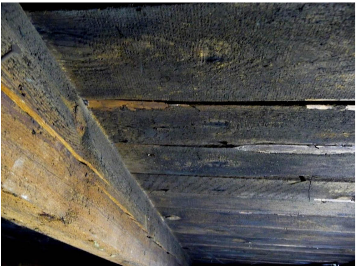
Bild 10: Schwarzfärbung der Dachschalung infolge der Ablagerung einer organischen Substratschicht;
