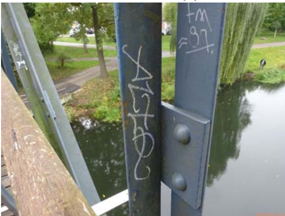
2023H-FW - KS BESCHÄDIGT
