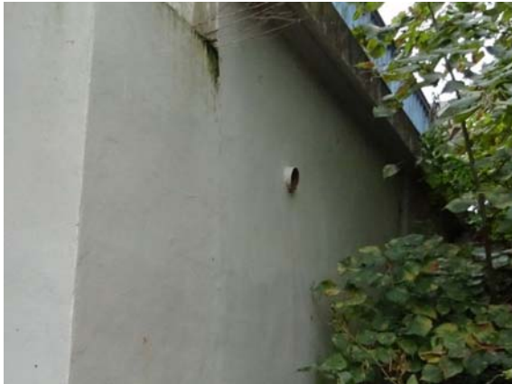
2023H-EW - ROHR ZU KURZ
