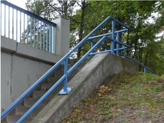
2023H-BÖSCH HI RE - ABGERUTSCHT
