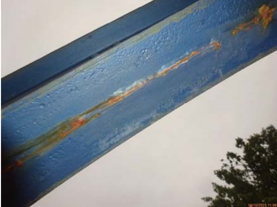
2023H-PORTAL UG - SPALTKORROSION
