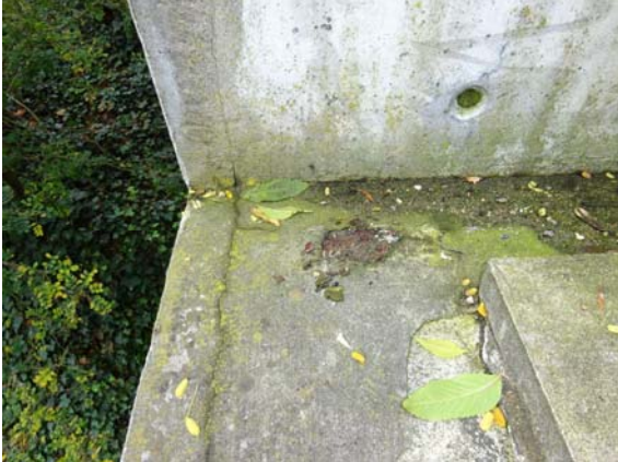
AUFLAGERBANK VORN - FREILIEGENDE BEWEHRUNG
