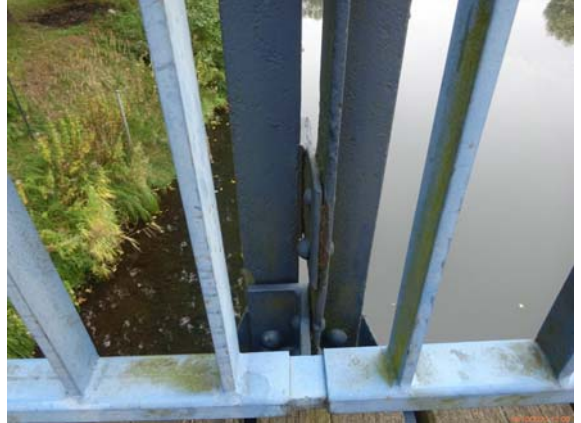
2023H-FW KNOTEN - SPALTKORROSION
