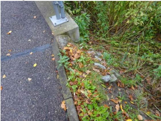
2023H-UFER - STEINE FEHLEN
