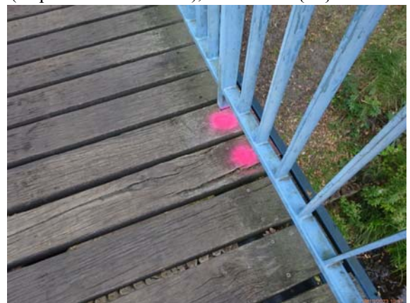
2023H-BELAG - BOHLEN VERSCHLISSEN
