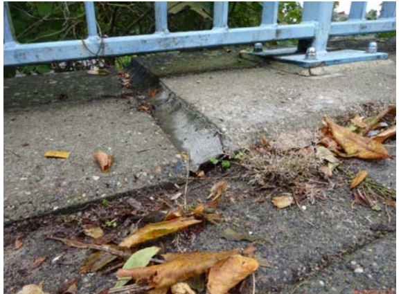
2023H-FLÜ - SETZUNG AN FUGE
