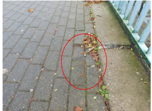
2020E_PFLASTER VORN ABGESACKT
