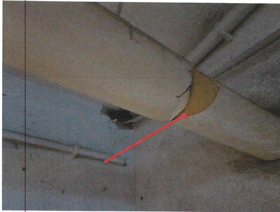
Abbildung 12: Dämmung an den Heizungssträngen „Keller“
