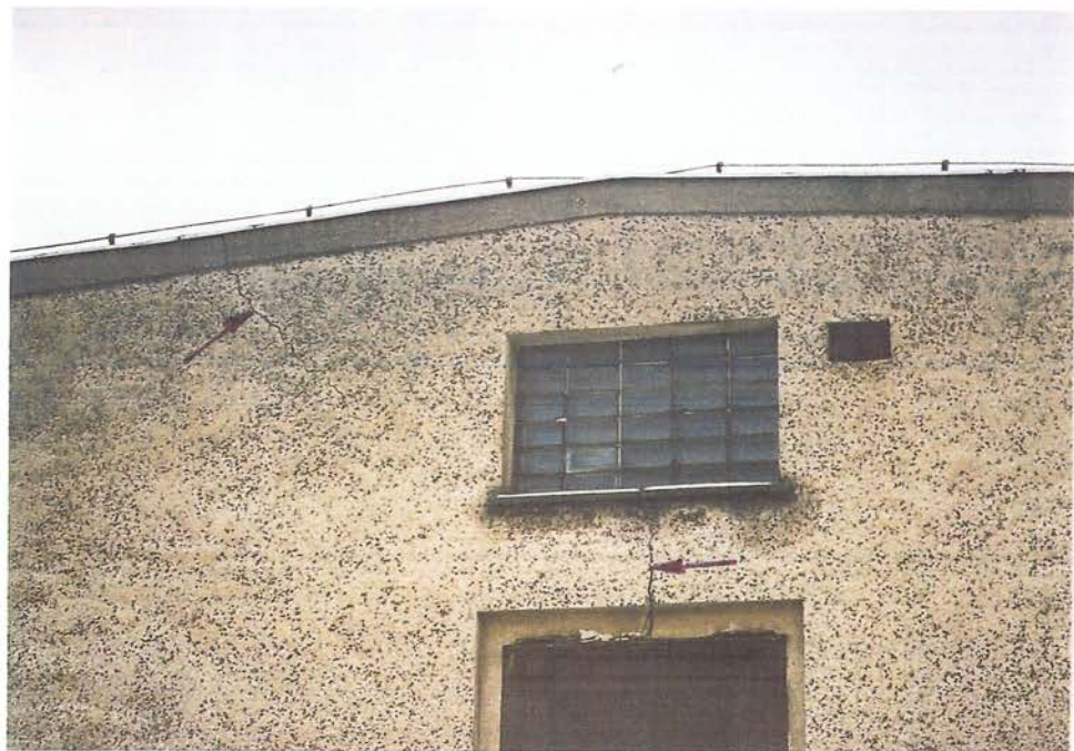
Gebäude 15, Westseite Ansicht und Detaildarstellung markanter Rissbildungen
