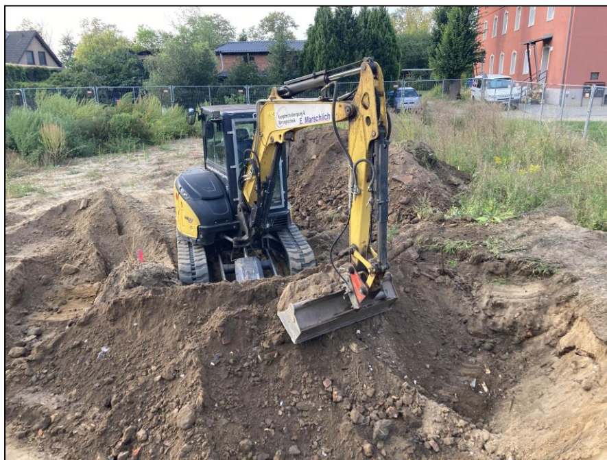
Abb. 7: Verfüllter Bombentrichter stark mit Bauschutt und Unrat durchsetzt
