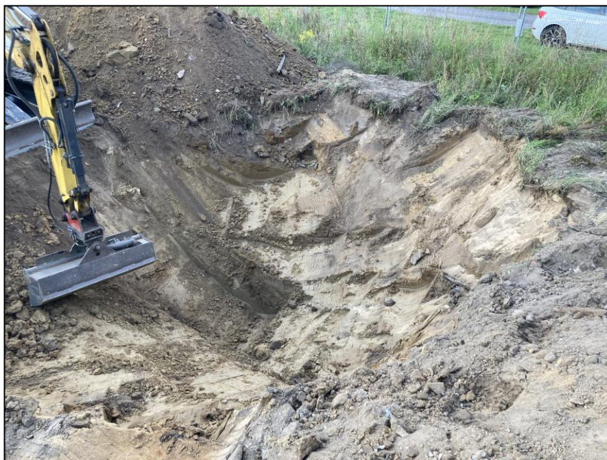
Abb. 8: Ansicht ausgebaggerter Bombentrichter
