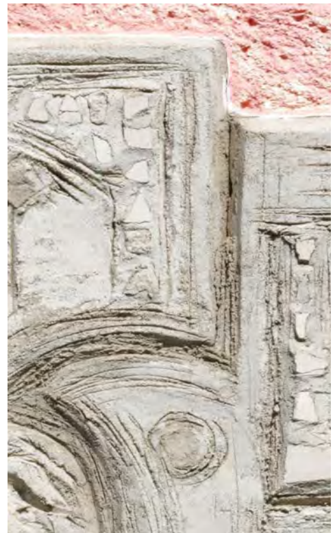
Abb. Nr.: 2 Unter der defekten Fuge ist die Werktechnik ersichtlich: segmentweise Herstellung und nachträgliches Schließen der Fugen
