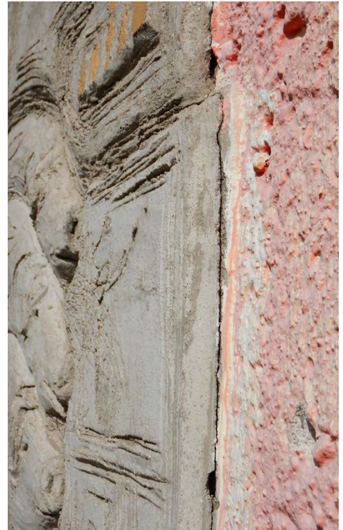
Abb. Nr.: 5 Rissverlauf im Anschlussbereich zum Untergrund
