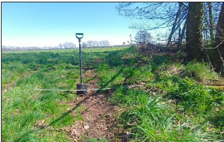
Abbildung 12: Geländeabsenkung über RDL TREB S13 (GV SPN, 2026)
