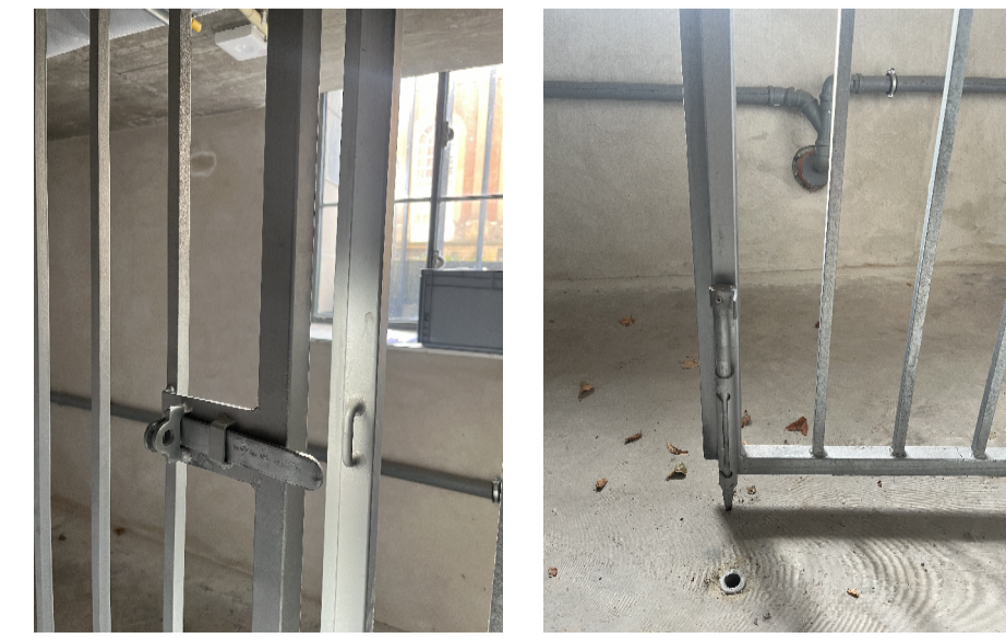
T K1.089b Bestand, Raum K1.032a Beispielbild Türverriegelung, Stahlriegel T K1.089b Bestand, Raum K1.032a Beispielbild Türverankerung im Boden
