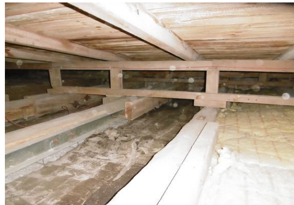
Abb. 32: Dachraum mit Partikeln in der Luft
