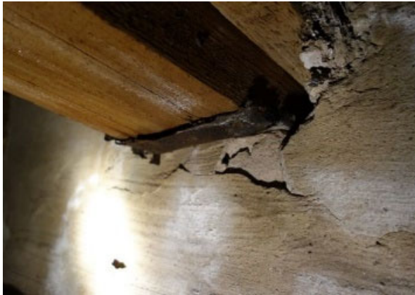
Abb. 29: Auflagerpappen unter Balken
