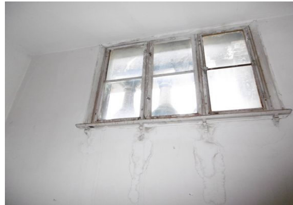
Abb. 36: Farbbeschichtung auf Fenstern mit Schwermetallverdacht
