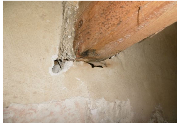
Abb. 30: Auflagerpappen unter Balken
