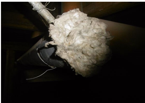
Abb. 33: KG diverse Positionen herumliegende Dämmwolle
