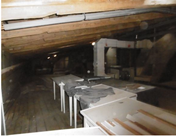
Abb. 7: Dachraum mit Lüftungskanälen
