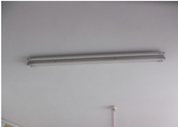
Abb. 35: Langfeldleuchte PCB- und Quecksilberverdacht
