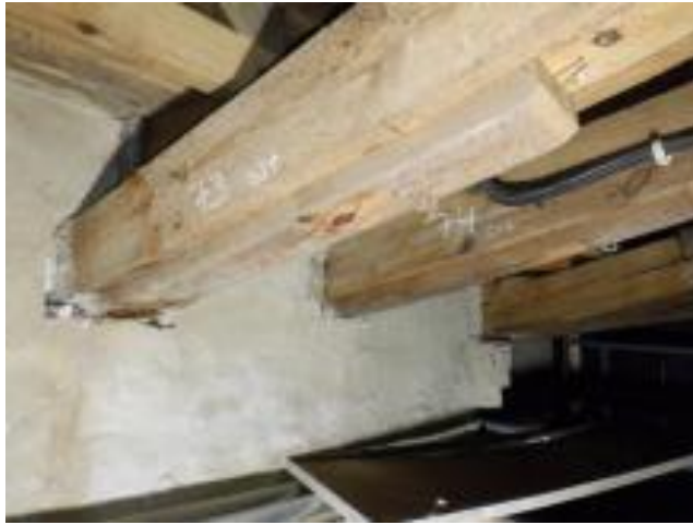
Heinrichbau Ostseite BTA 73 – 74 alte Reparaturen
