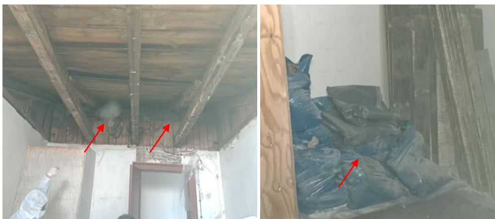
Foto 3: Einbauort KMF, KMF-Dämmung verpackt in Säcken
