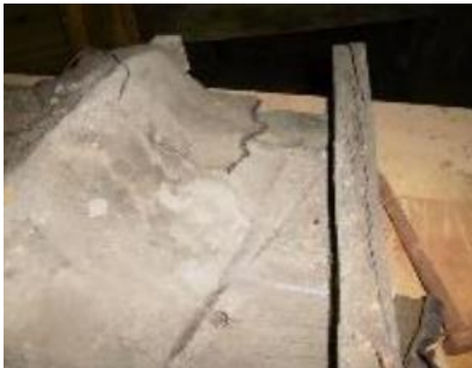
Foto 4: Einbauort PAK-haltige Dachpappe. Quelle: Orientierende Gebäudeschadstofferkundung von ARCADIS vom 18.06.2020.
