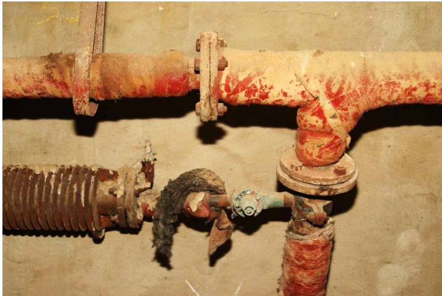
Abb.: 4 Heizungsrohre mit angeschlossenem Rippenheizkörper
