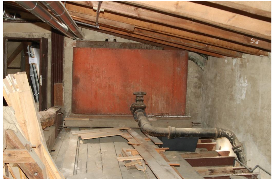
Abb.: 5 Vorratstank mit Zuleitungen für den Aufzug
