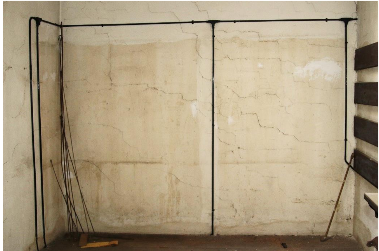
Abb.: 15 Kabelkanäle zur Elektroinstallation
