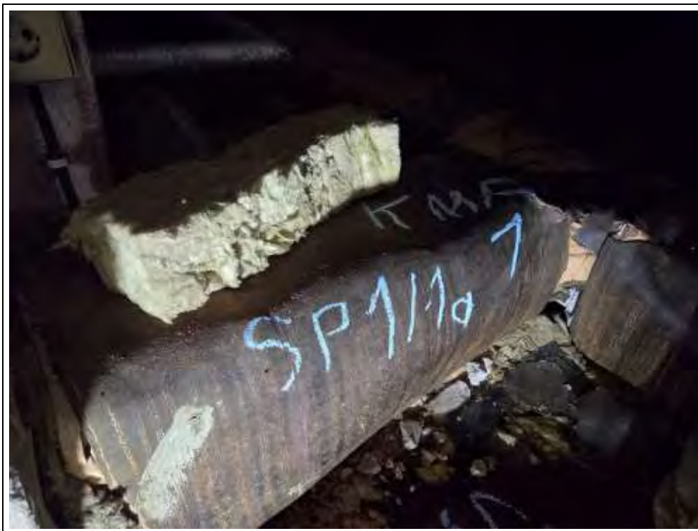
Foto 17: Blick in den südlichen Drenpelbereich. In dem Drenpel sind vollflächig 10,0 cm starke KMF-Matten ausgelegt, die über die Probe KMF 1 erfasst wurden. Die hier verlaufenden Lüftungskanäle sind mit einer Dachpappe (Proben SP 1 und SP 1a) ummantelt und KMF-gedämmt (Probe KMF 3).
