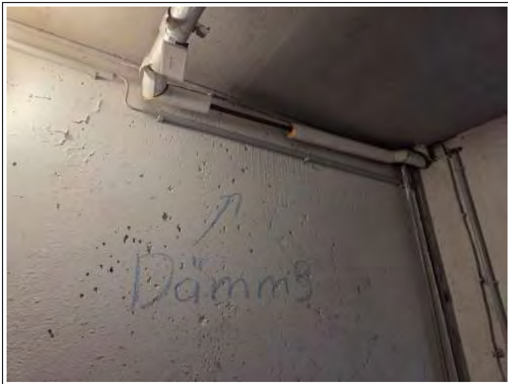
Foto 26: Die älteren Rohrisolierungen im Keller umfassen Formschalen aus Schaumpolystyrol und wurden über die Probe Dämm 3 erfasst.
