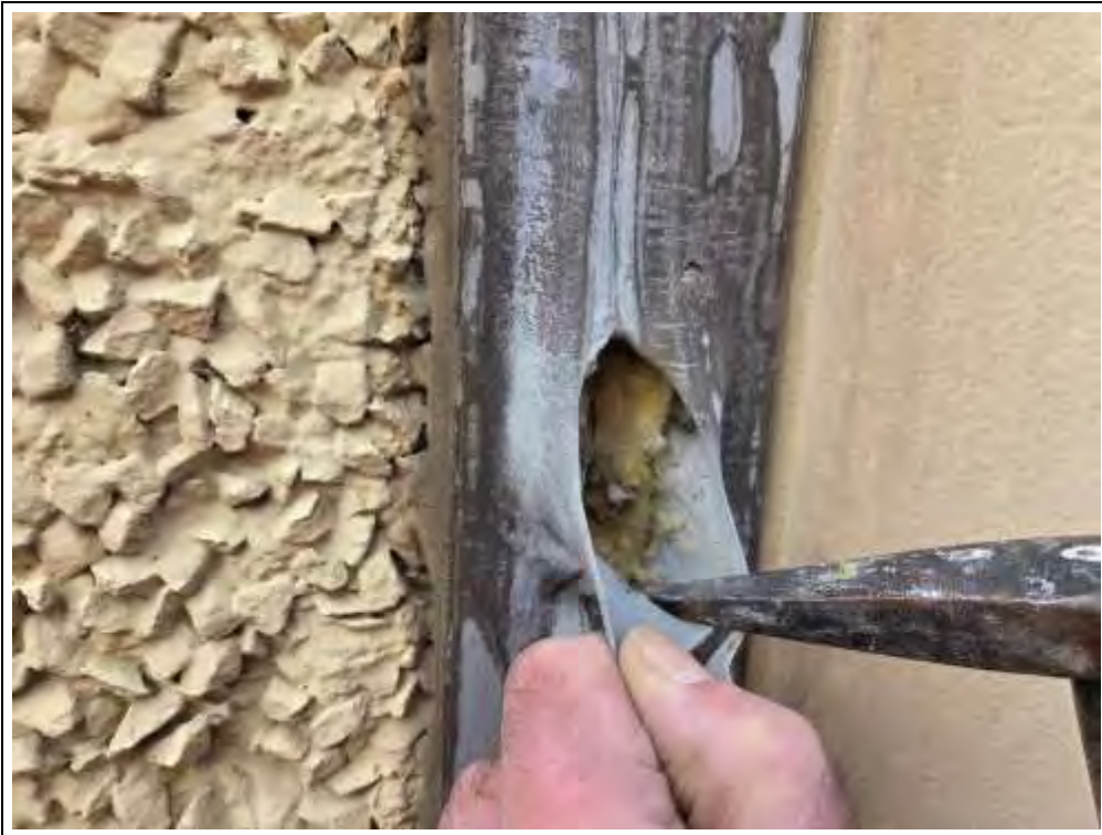
Foto 13: Die weiteren Untersuchungen zeigten, dass sowohl KMF- als auch Morinoldichtungen verwendet wurden. Im Bild eine weitere KMF-Dichtung an der Außenwand.
