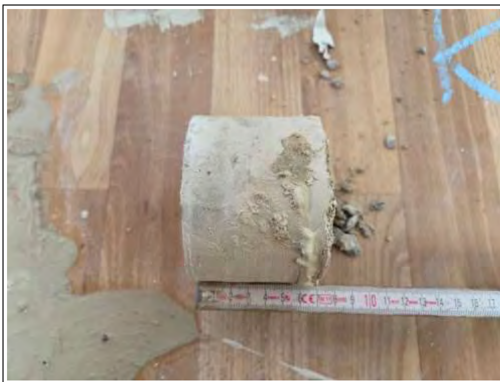
Foto 30: Detailansicht des 6,5 cm starken Estrichbohrkernes der KB 1. Die Estrichbohrkerne wurden zu einer Mischprobe zusammengefasst und untersucht.
