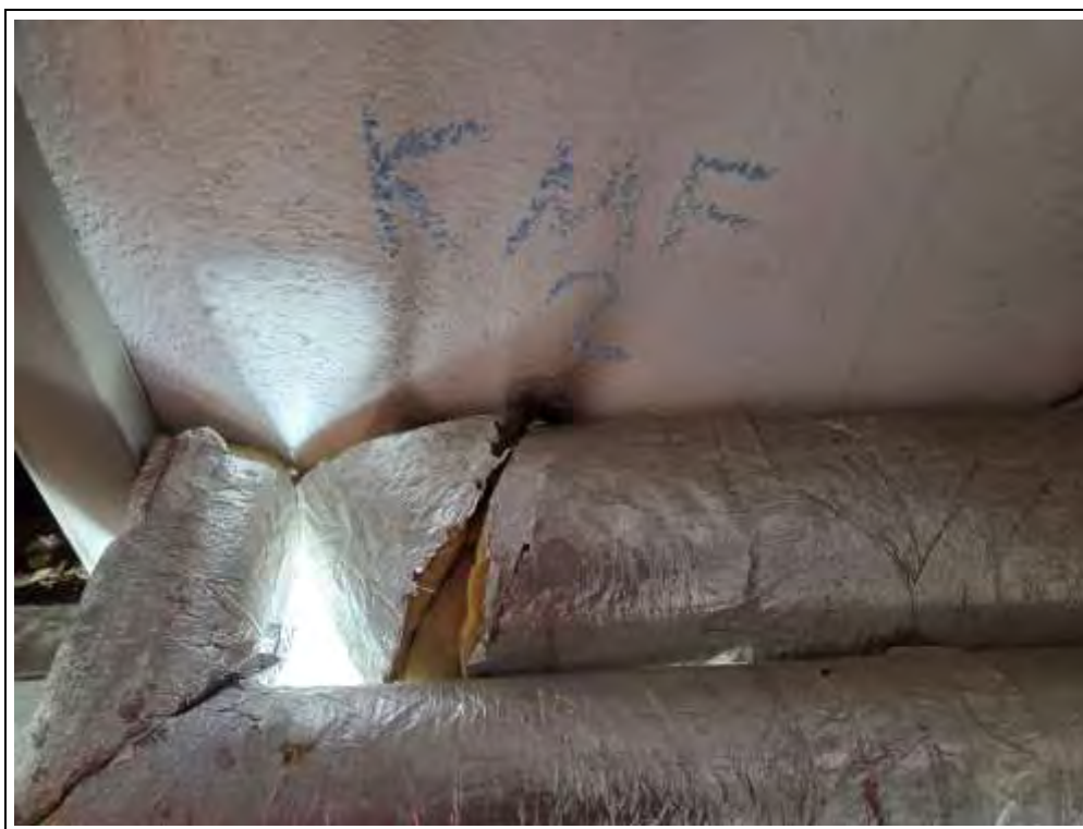
Foto 19: Im Drempel und vor dem Drempel verlaufen Rohrleitungen mit alukaschierter KMF-Dämmung. Diese neuere Dämmung wurde mit der Probe KMF 2 erfasst.
