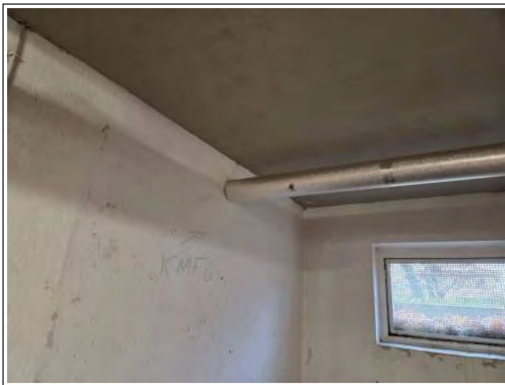
Foto 24: In dem Keller des Gebäudes verlaufen diverse Rohrleitungen mit neueren und älteren Isolierungen. Die neueren Isolierungen bestehen aus alukaschierter Mineralwolle und wurden hier über die Probe KMF 6 erfasst.
