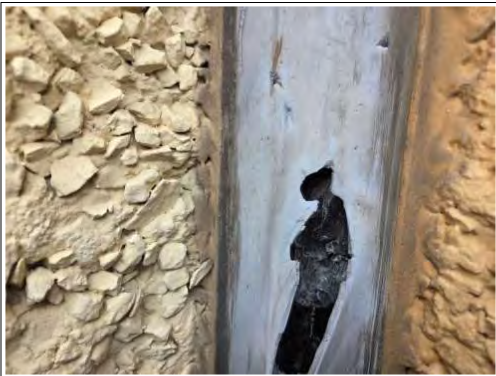
Foto 14: Vertikalfuge aus Morinol unter der Gummilasche am Gebäudeversatz. Entnahmepunkt der Probe Fuge 3 M.
