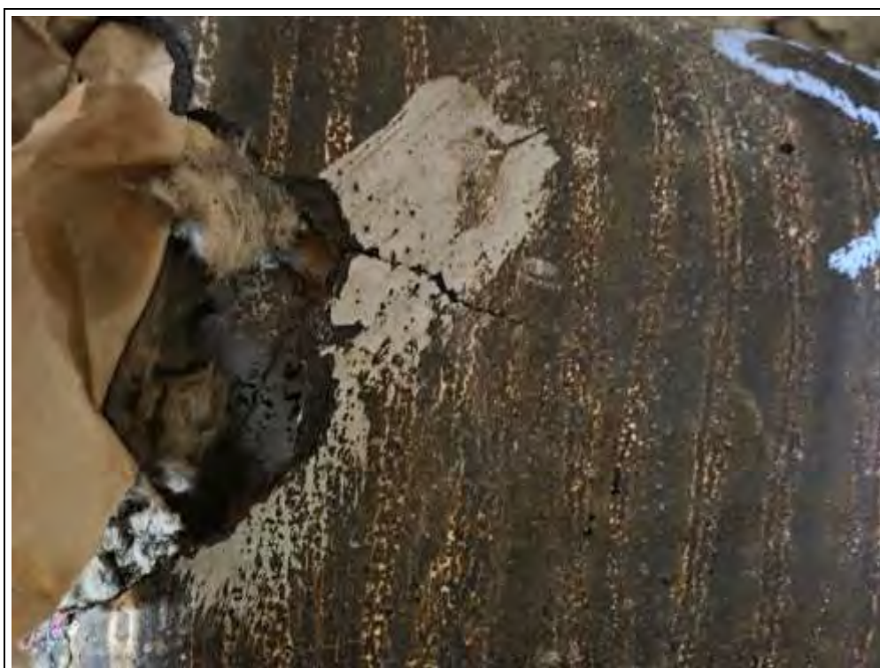
Foto 20: Probenahmepunkt an einem Lüftungskanal im Drempel, aus dem die Probe KMF 3 entnommen wurde. Die KMF-Dämmung des Lüftungskanales war hier 4,0 cm stark.
