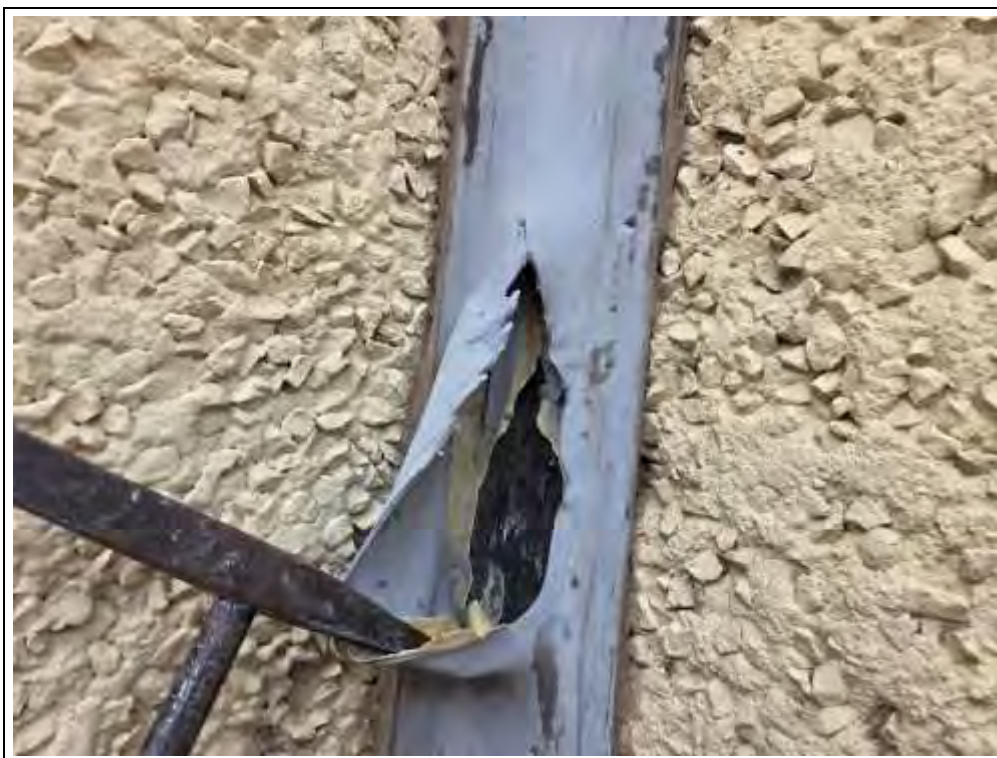
Foto 16: Vertikalfuge aus Morinol unter der Gummilasche an der Balkonaußenseite.
