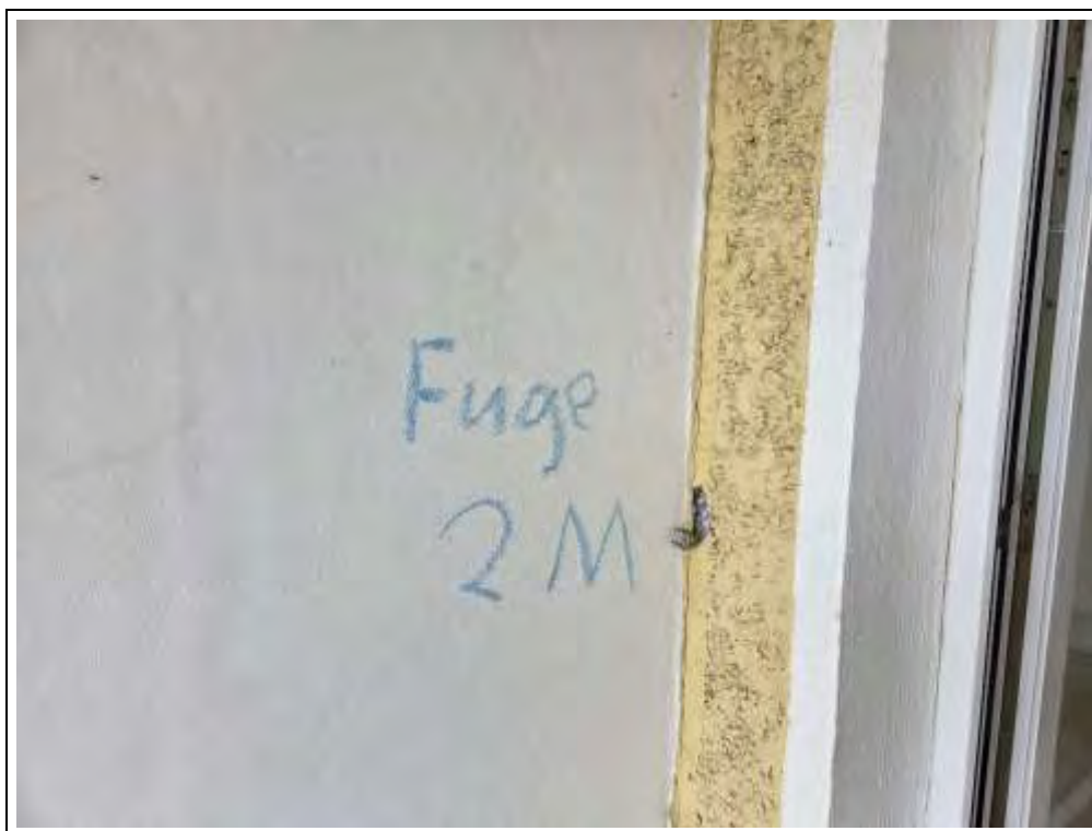
Foto 11: Fugendichtungen aus Morinol wurden auch in den vertikalen inneren Eckfugen der Balkone am Südgiebel festgestellt. Im Bild sichtbar ist die Entnahmestelle der Probe Fuge 2 M.
