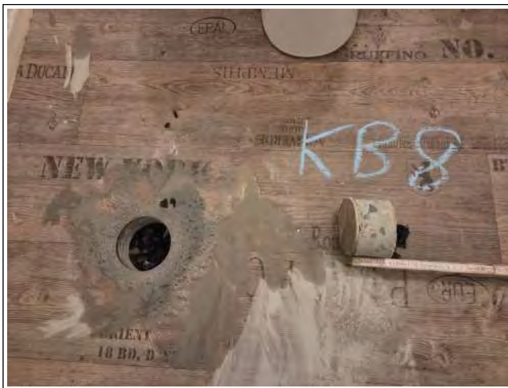
Foto 39: Ansatzpunkt und Bohrkern der Kernbohrung KB 8 im Bad der Wohnung im EG.
