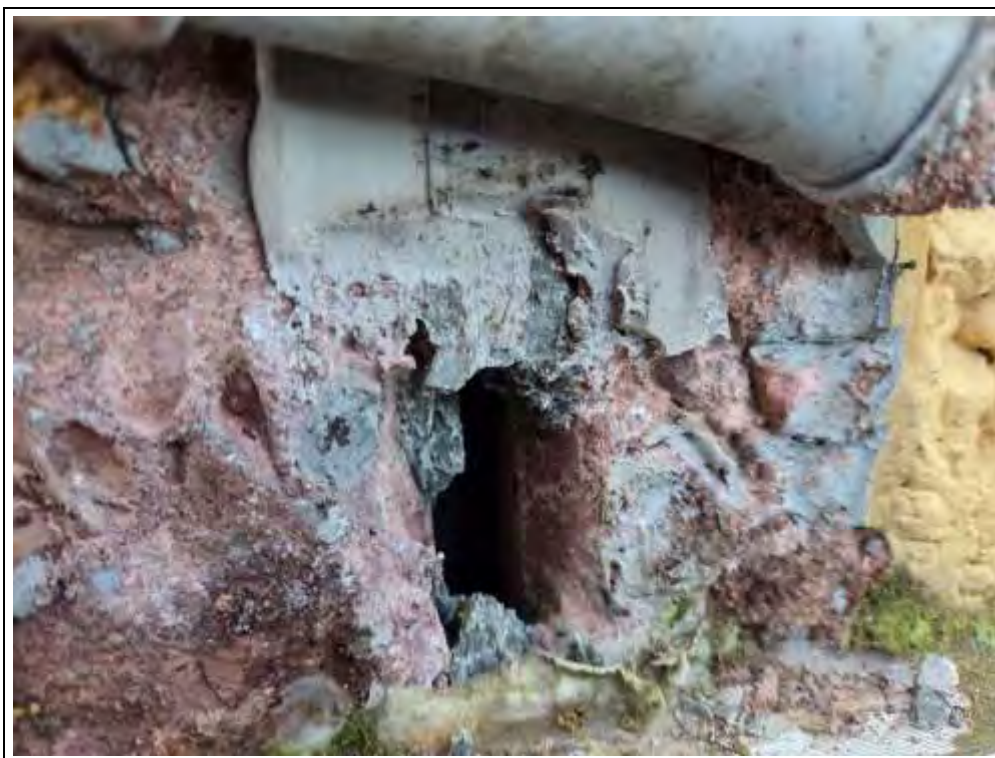
Foto 10: Nach der Ablösung der Gummimanschette an einer Fuge des höher gesetzten Mittelteils auf dem Dach wurde festgesellt, dass als Fugenmaterial unter der Gummischicht auch Morinol eingesetzt wurde. Die Fugendichtung aus Morinol wurde hier über die Probe Fuge 1 M (das M steht für Morinol) erfasst.
