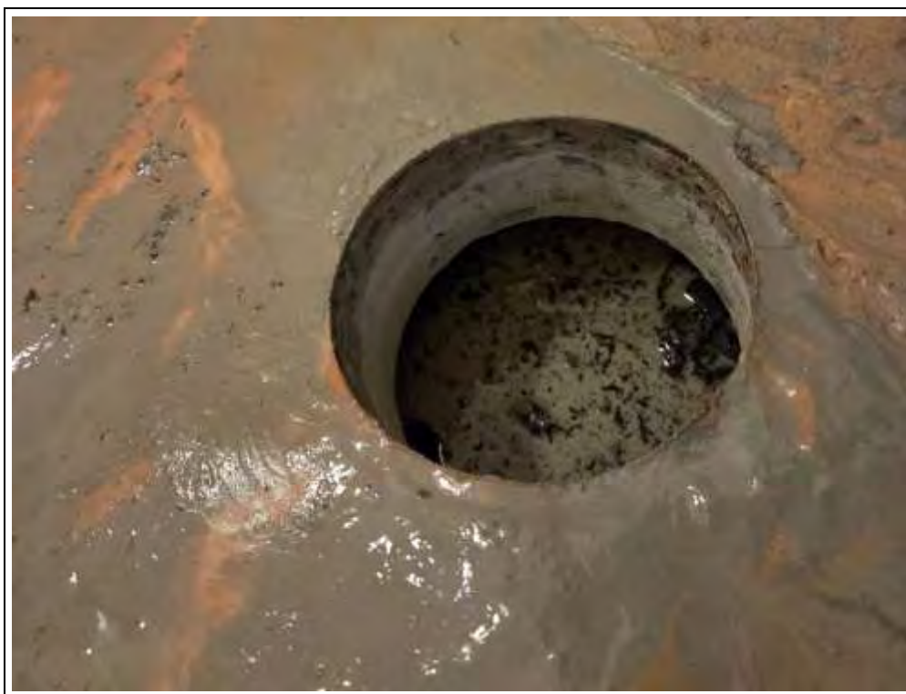
Foto 33: Detailsicht des Ansatzpunktes der Kernbohrung KB 3 mit den sichtbaren Resten der Gummischüttung.
