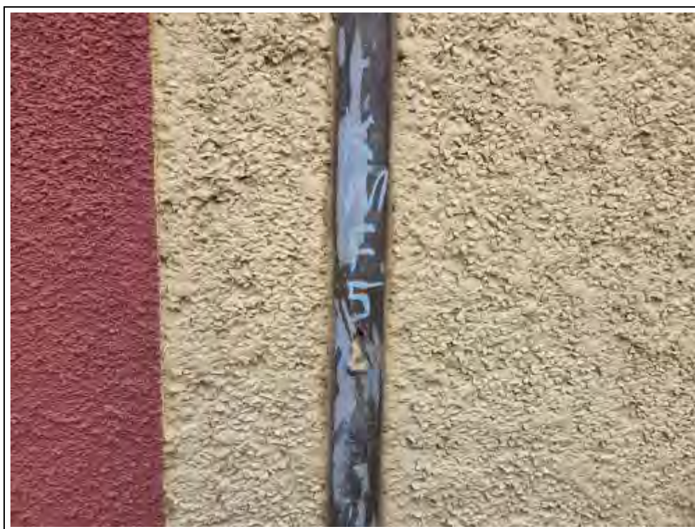
Foto 12: Weitere Fugen in der Außenwand wurden im unteren Gebäudebereich von Gelände aus geprüft. Dabei wurde neben Morinol auch KMF als Fugendichtung festgestellt. Diese wurde hier über die Probe KMF 5 erfasst.
