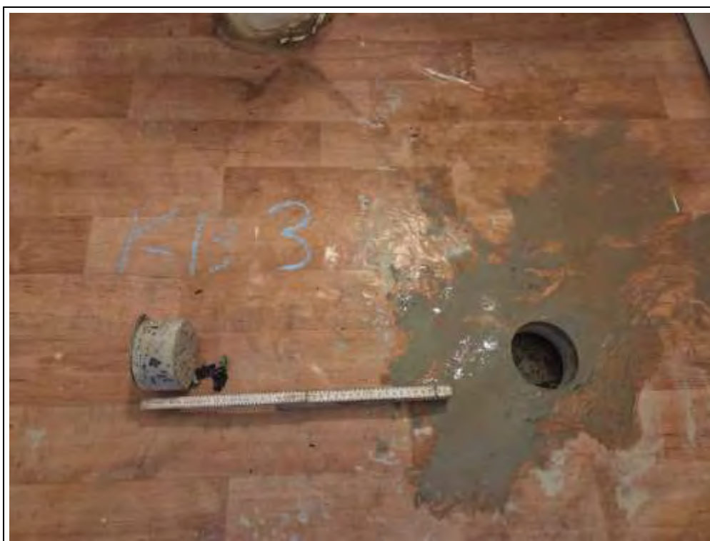
Foto 32: Ansatzpunkt und Bohrkern der Kernbohrung KB 3 im Bad der Wohnung 59 im 5. OG. Es sind keine Dämmung und keine Sperrlage vorhanden. Der sichtbare Hohlraum unter dem Betonestrich enthält eine Gummischüttung, auf der die Sanitärzellen insgesamt abgesetzt wurden.
