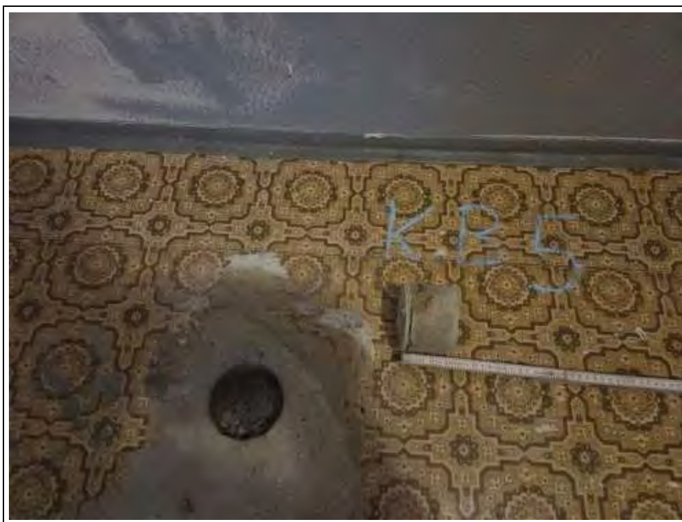
Foto 35: Ansatzpunkt und Bohrkern der Kernbohrung KB 5 im Flur der Wohnung im 4. OG. Es sind keine Dämmung und keine Sperrlage vorhanden.
