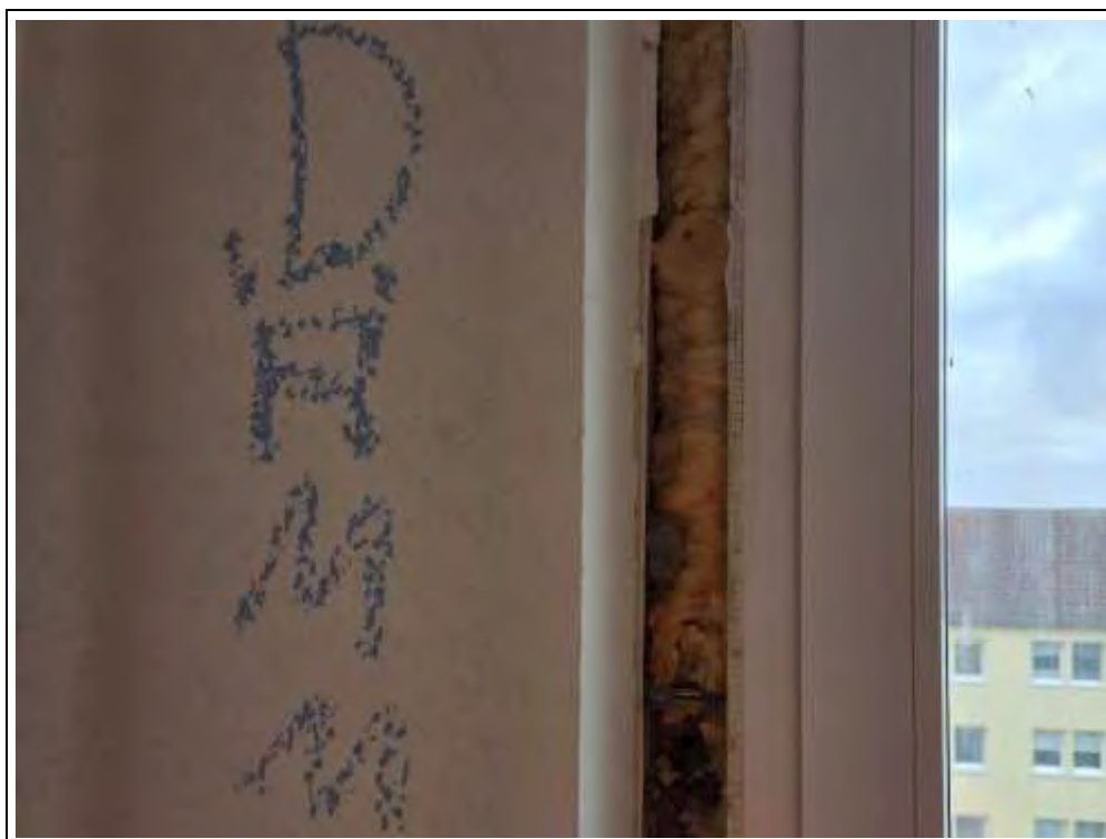
Foto 23: Das Fenster wurde gegenüber der Wandplatte mit Bauschaum gedichtet. Der Bauschaum wurde über die Probe Dämm 1 erfasst.
