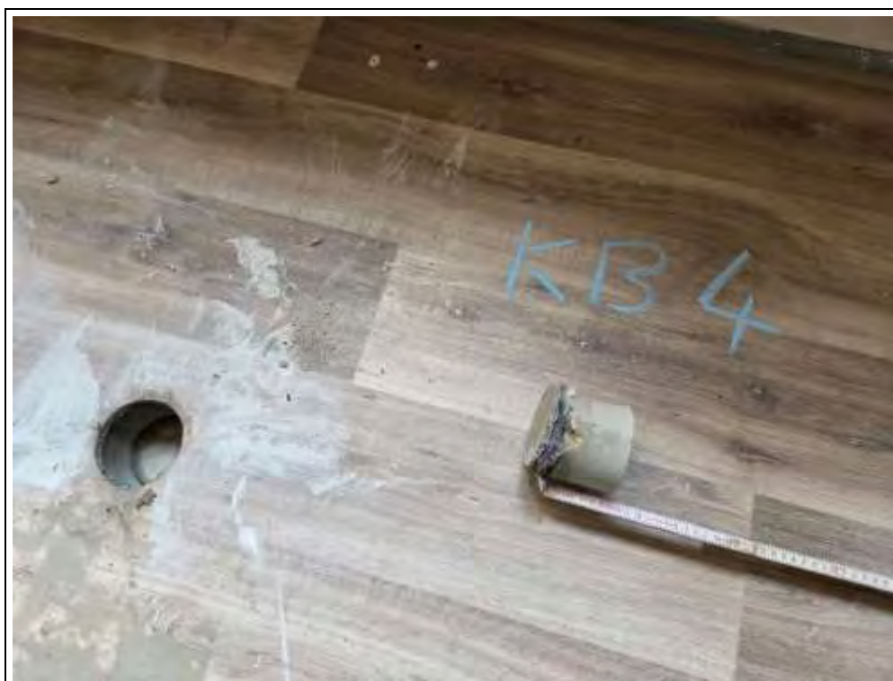
Foto 34: Ansatzpunkt und Bohrkern der Kernbohrung KB 4 im Wohnzimmer der Wohnung im 4. OG. Es sind keine Dämmung und keine Sperrlage vorhanden.
