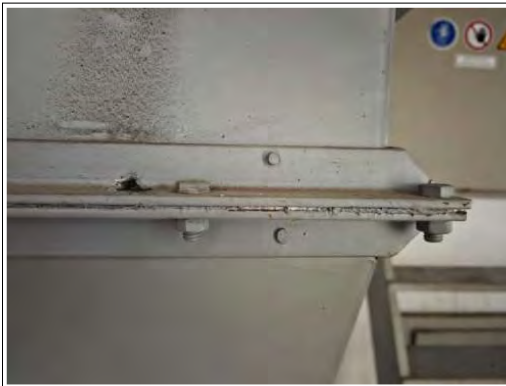
Foto 21: Asbesthaltige Dichtschnur (Probe Asbest 1) an einer Flanschdichtung des Lüftungssystems im Treppenhaus des höher gesetzten Gebäudemittelteils zwischen den beiden Drempeln.
