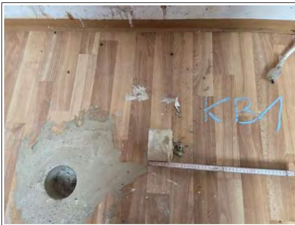
Foto 29: Ansatzpunkt und Bohrkern der Kernbohrung KB 1 in der Küche der Wohnung 59 im 5. OG. Es sind keine Dämmung und keine Sperrlage vorhanden.
