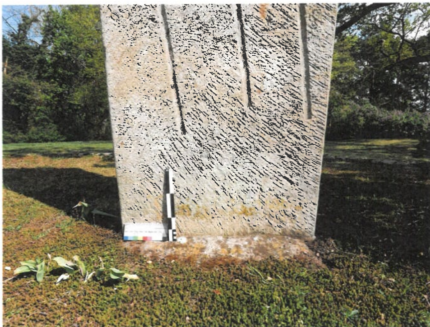
Abbildung 13 Freigespültes Fundament an der Stele
