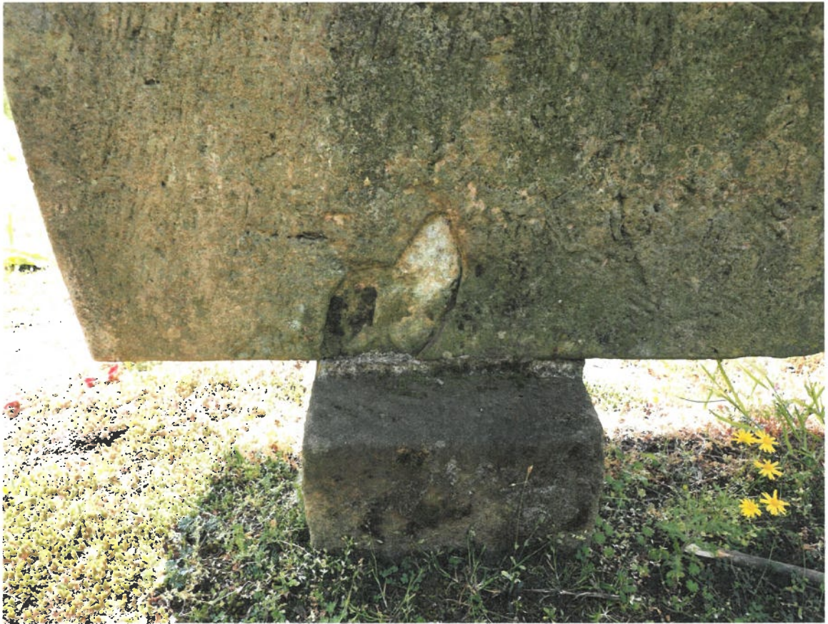
Abbildung 14 Fehlstelle mit entfestigtem Bereich
