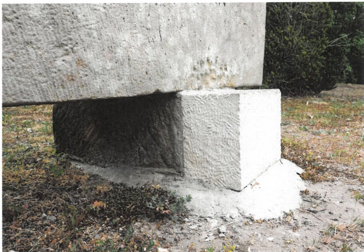
Abbildung 17 Vierung und Schäden über der Fuge
