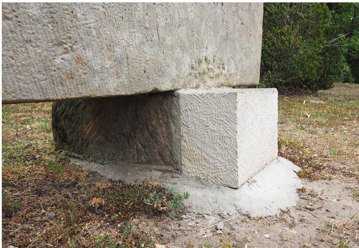
Abbildung 17 Vierung und Schäden über der Fuge
