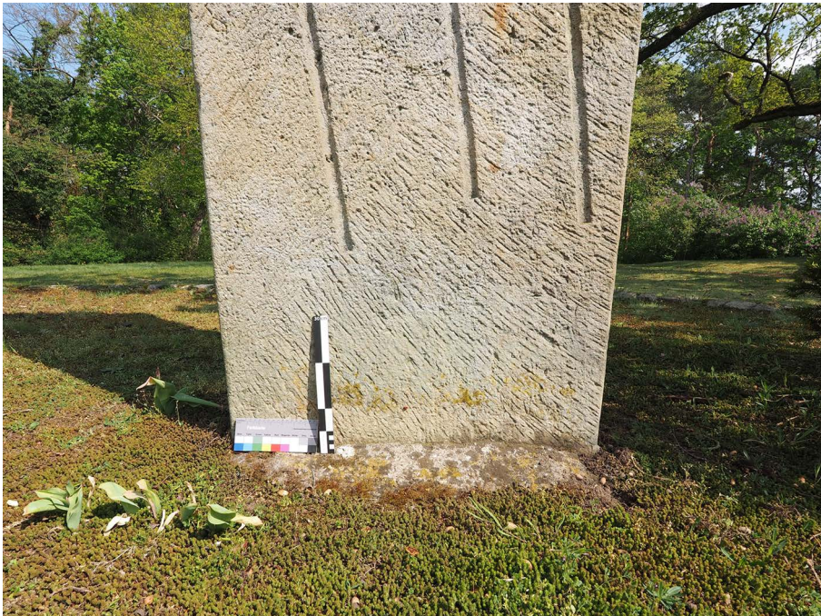
Abbildung 13 Freigespültes Fundament an der Stele
