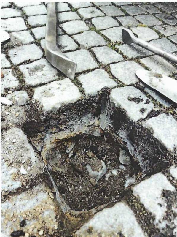
Foto: Forst/Lausitz, Muskauer Straße – A2 (Aufbruch)
