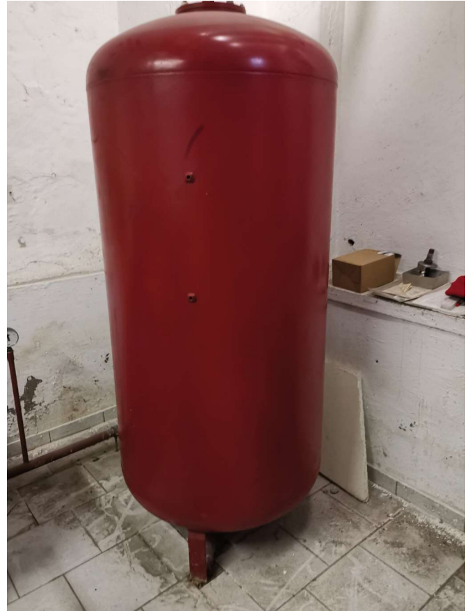
Ausdehnungsgefäß UG Heizraum
