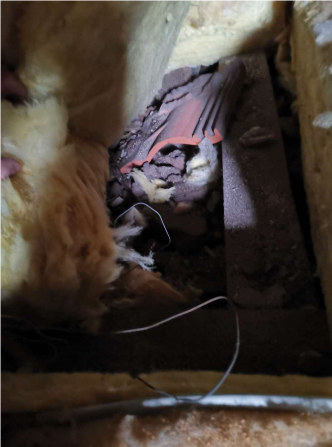
Schutt auf Decke Saal
