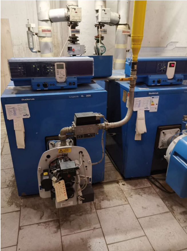
Heizthermen im abgetieften Kellerbereich
