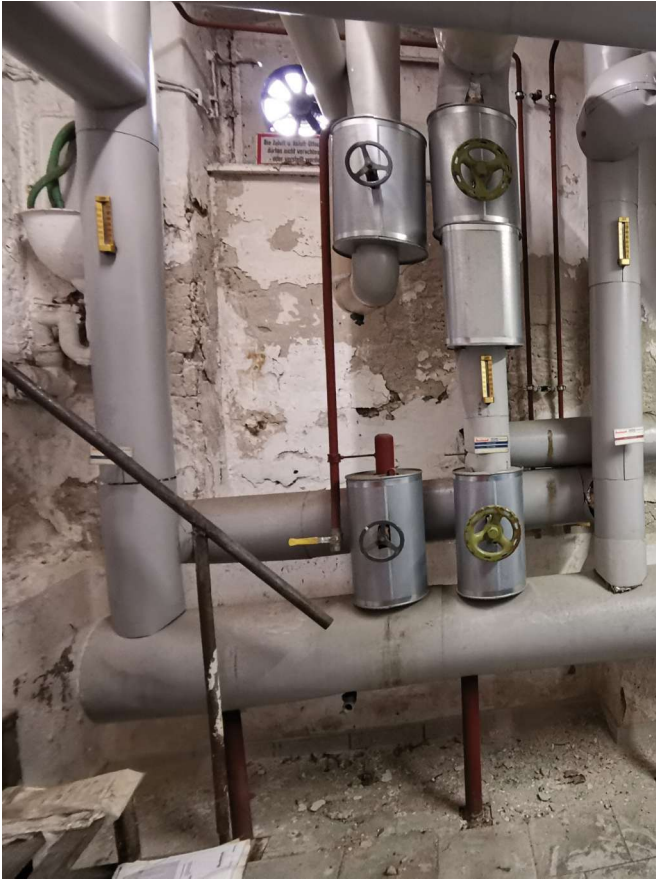
gedämmte Verteiler im UG Heizraum
