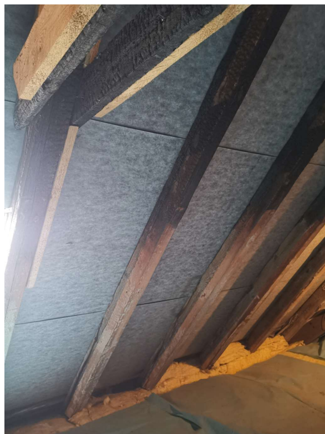
Unterdeckbahn und Brandschaden
