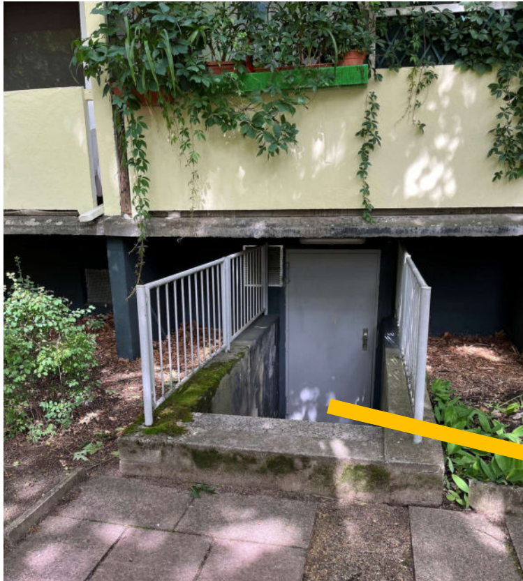
Abb. Nr. 8: Saarmunder Str. 18, Fassade Süd und Zugang zur HA-Station
