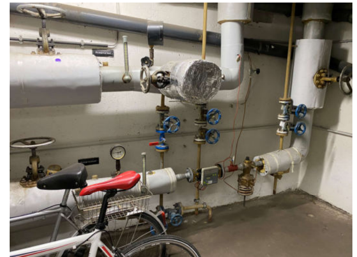
Abb. Nr. 44: Saarmunder Str. 18, KG; Wärmeübergabestation
