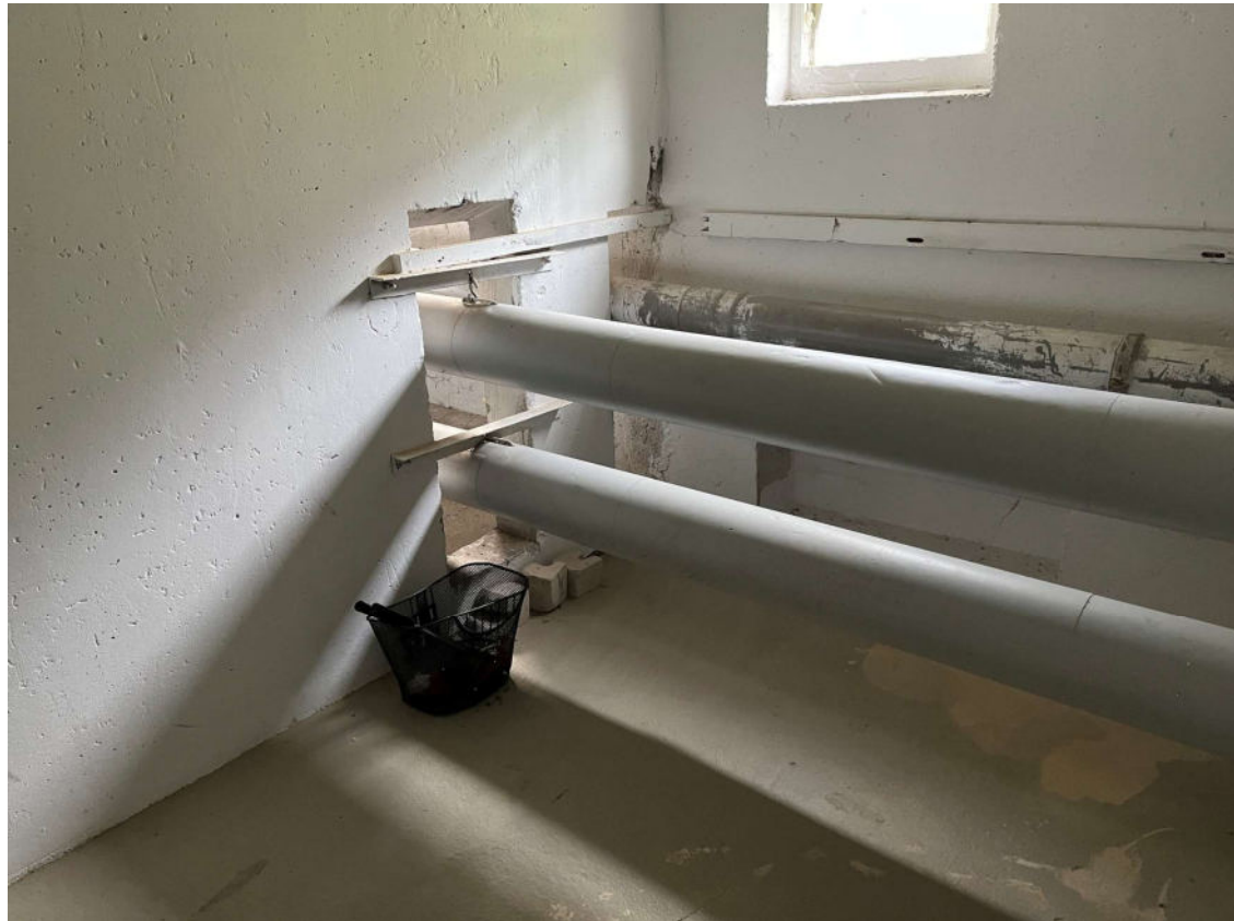
Abb. Nr. 45: Saarmunder Str. 14, KG, Heizung, Wanddurchführung
