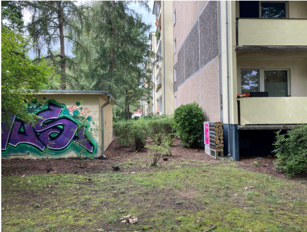
Abb. Nr. 10: Saarmunder Str. 18, Fassade West, Trafo im Innenhof
