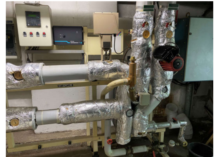
Abb. Nr. 41: Saarmunder Str. 18, HUST – TW-Station
