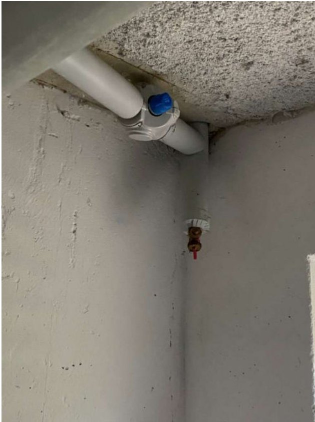
Abb. Nr. 32: Saarmunder Str. 14, Kellergeschoss, Absperrventil für Heizung, Rücklauf (blau)
