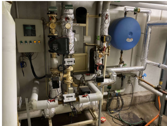
Abb. Nr. 43: Saarmunder Str. 18, HUST – TW-Station
