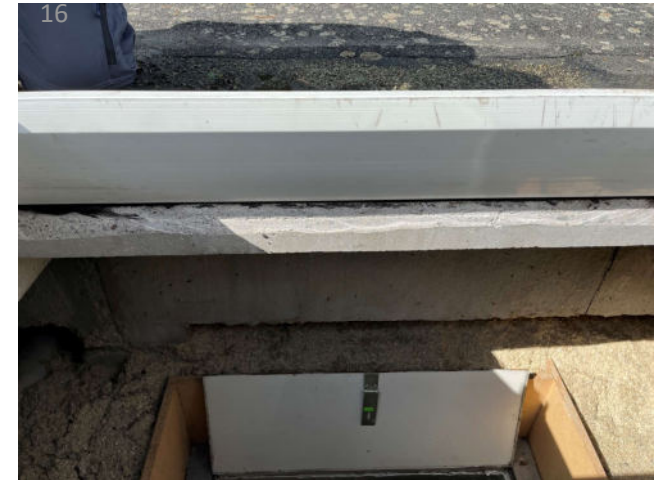
Abb. Nr. 22: Dachausstieg und Wärmedämmung über letzter Geschoßdecke mit Mineralwollebahnen BBP 60/30, lose verlegt
