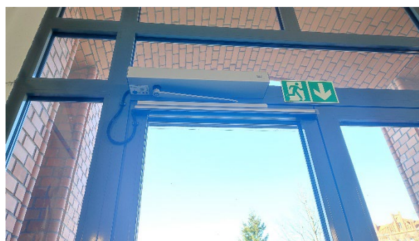
Tür und Türantrieb Haus A mit Taster an der Seite zur Betätigung der Tür
