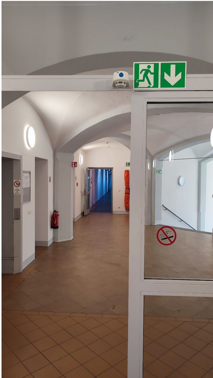
Abbildung 5, Rauchmelder an Tür
