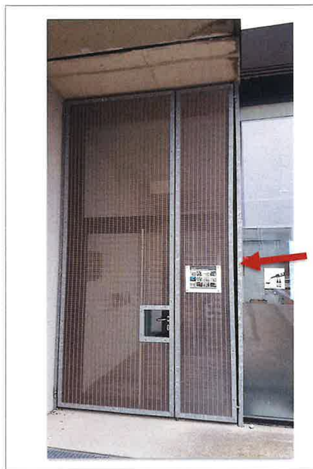
Bild 3-2: Verformungen im Eingangsbereich (Foto 07.01.2021)
