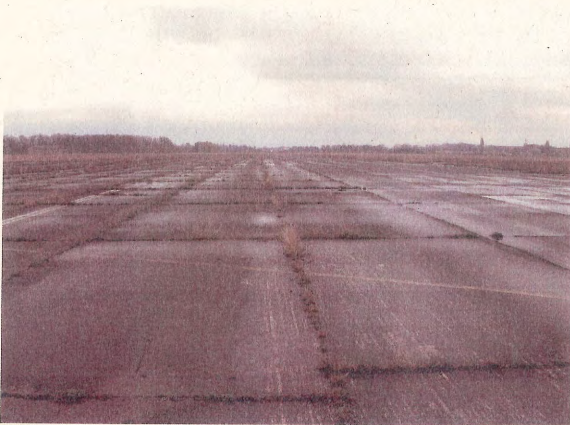
Foto 5: Die vor Ort gegossenen Betonplatten sind flächendeckend mit einer Bitumenversiegelung (Probe P 2, 0,5 cm) versehen.
