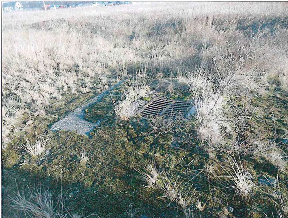
Foto 2: verbliebener Regenwassereinlauf im Ostbereich der ehemaligen Kreuzlandebahn
