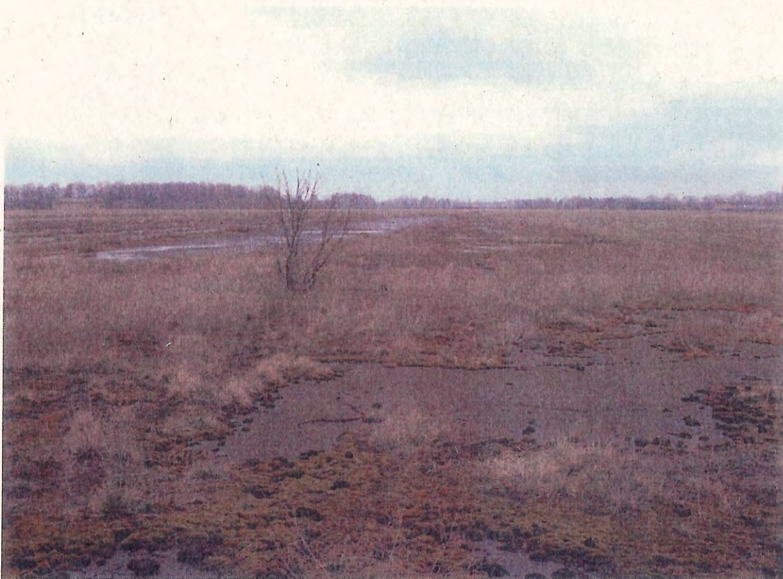
Foto 1: Historisches Start- und Landekreuz (Blickrichtung Südost) - stark verwitterte und bewachsene Asphaltdecke.
