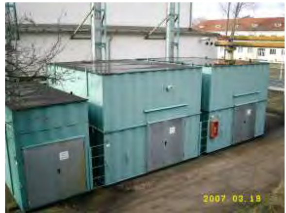
Heizcontainer mit Ausstattung
