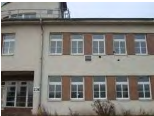
herunterhängende Blitzableiter-Leitungen und fehlende Regenrinnen, östliche Südfassade
