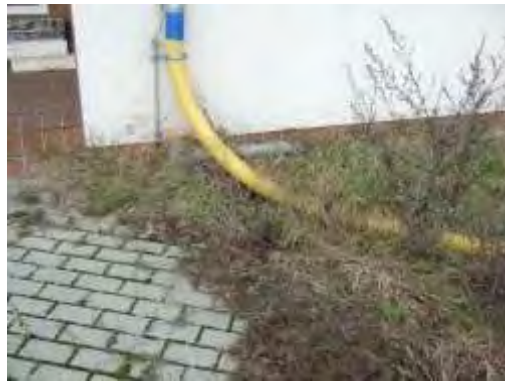
Fallrohrzustand vor dem linken Eingangsbereich
