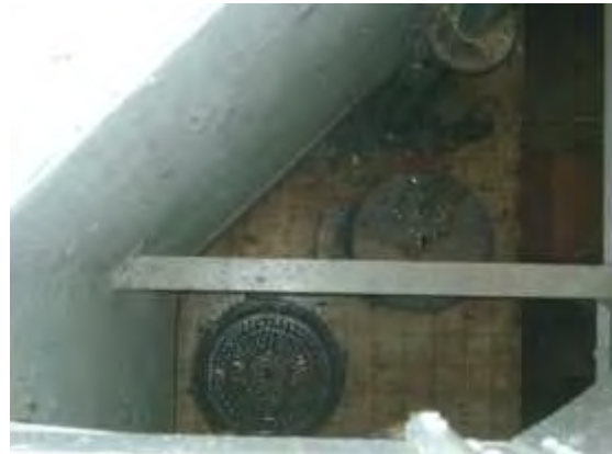
Blick in die Abwasserpumpanlage
