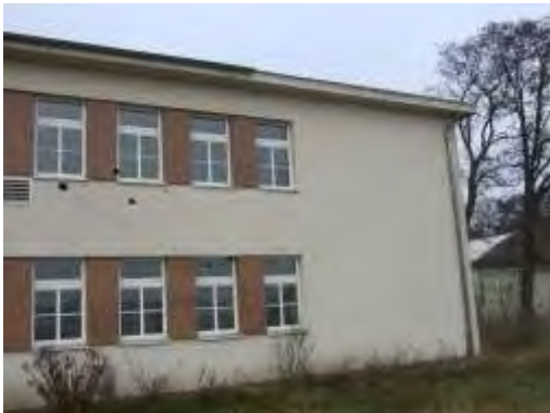
herunterhängende Blitzableiter-Leitungen vor der östlichen Südfassade
