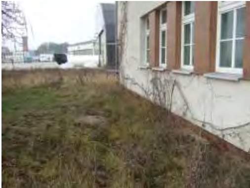
Fallrohrzustand an der westlichen Südfassadenecke
