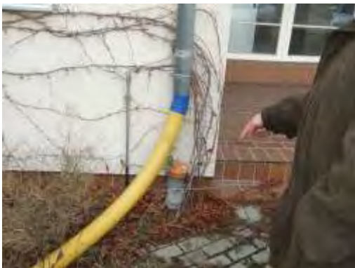
Fallrohrzustand vor dem Eingangsbereich, rechts
