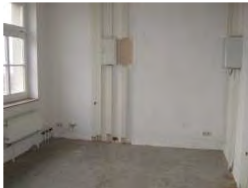
z.T. leere Kabeltrassen, 1. OG
