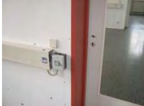
Zustand eines Kabelkanaldetail, Tapetenzustand, fehlende Türklinken, EG
