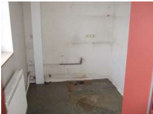
Wand- und Fußbodenzustand der ehemaligen Teeküche, westlicher Seitenflügel, EG
