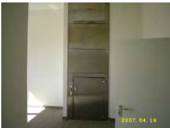
Lastenaufzug, war nicht in Betrieb weil keine Kellernutzung erfolgt
