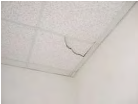
Akustik-Trockenbau-Rasterdecke, hier mit Beschädigung 1. OG
