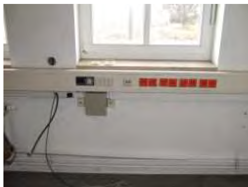
Kabelkanäle, Südseite, EG
