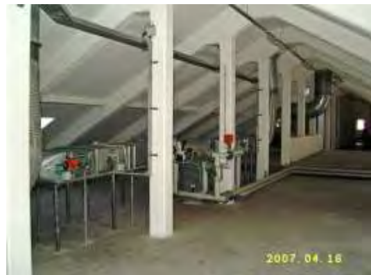
Klima-Lüftungsanlage auf dem Dachboden, nicht in Funktion
