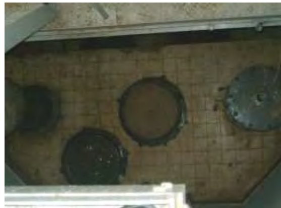
Blick in die Abwasserpumpanlage
