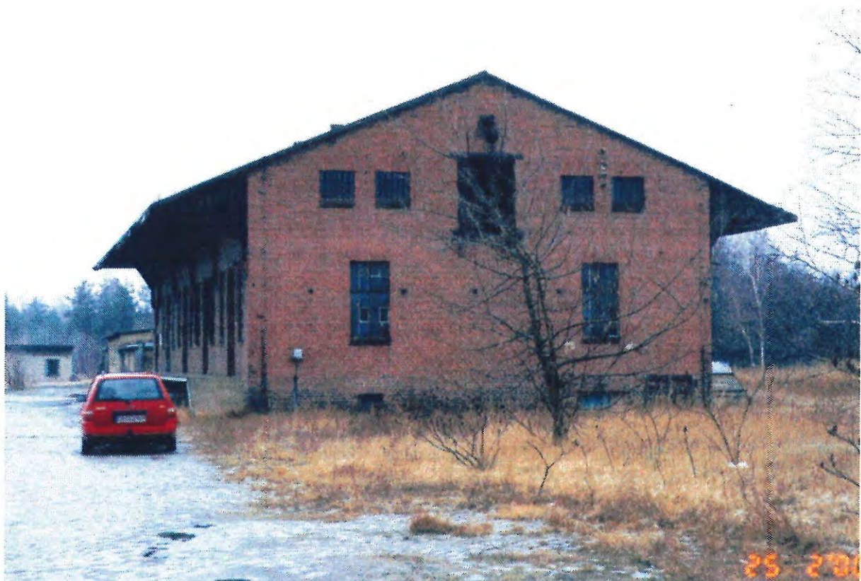
Foto 4: Das unterkellerte Gebäude ist beidseitig mit Laderampen ausgestattet, giebelseitig erfolgte die Beförderung von Gütern durch eine Seilwinde in das Obergeschoß. Blick nach NNE.
