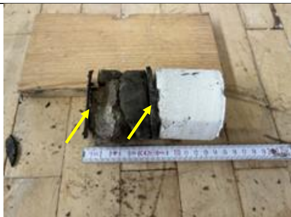
Sporthalle – Bohrkern aus Hallenboden mit asbesthaltigen Abdichtungsbahnen
