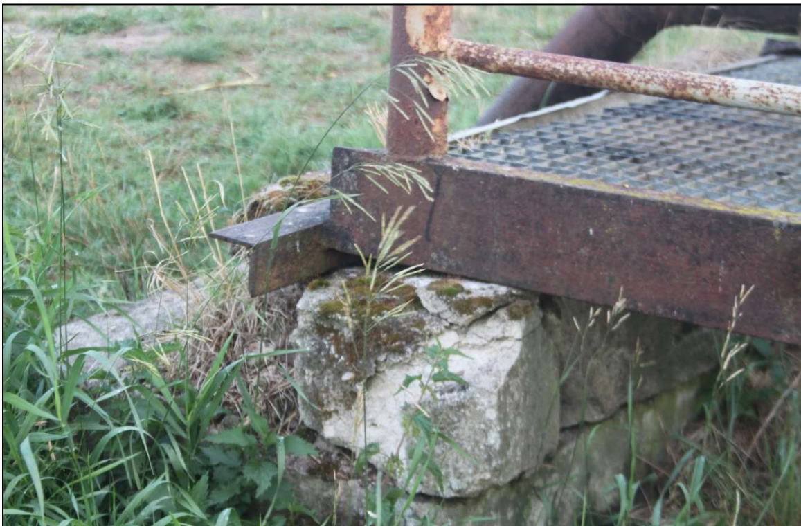
Abbildung 19: Mangelhaftes Endauflager Hauptträger Bediensteg, linkes Ufer (08/2018)
