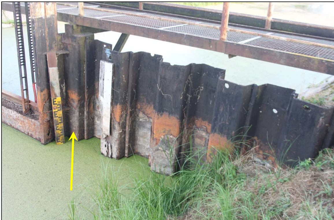
Abbildung 9: Spundwandpfahl Oberwasser, rechts (08/2018)
