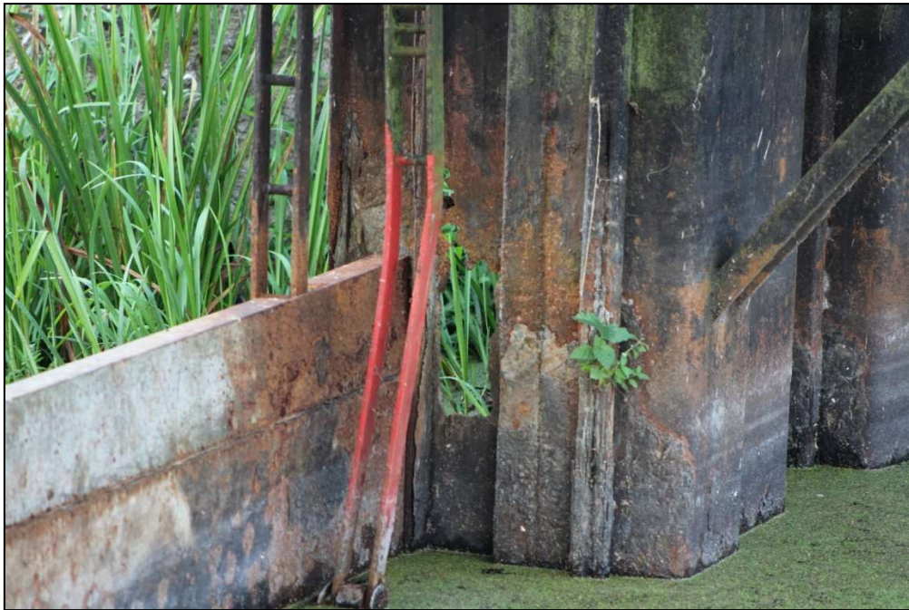
Abbildung 12: Deformierter Triebstock Unterschütz, Blick in Richtung OW (08/2018)
