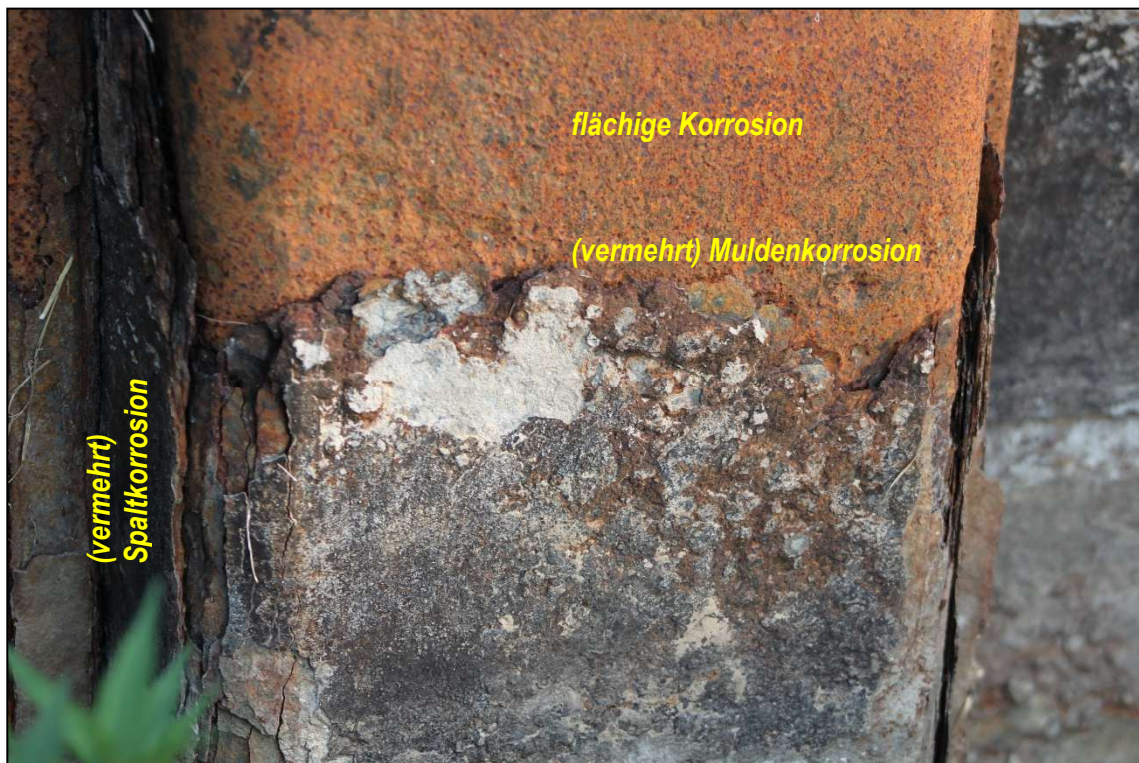
Abbildung 8: Korrosion Stahlspundwand, Oberwasser links, Wasserwechselzone (08/2018)
