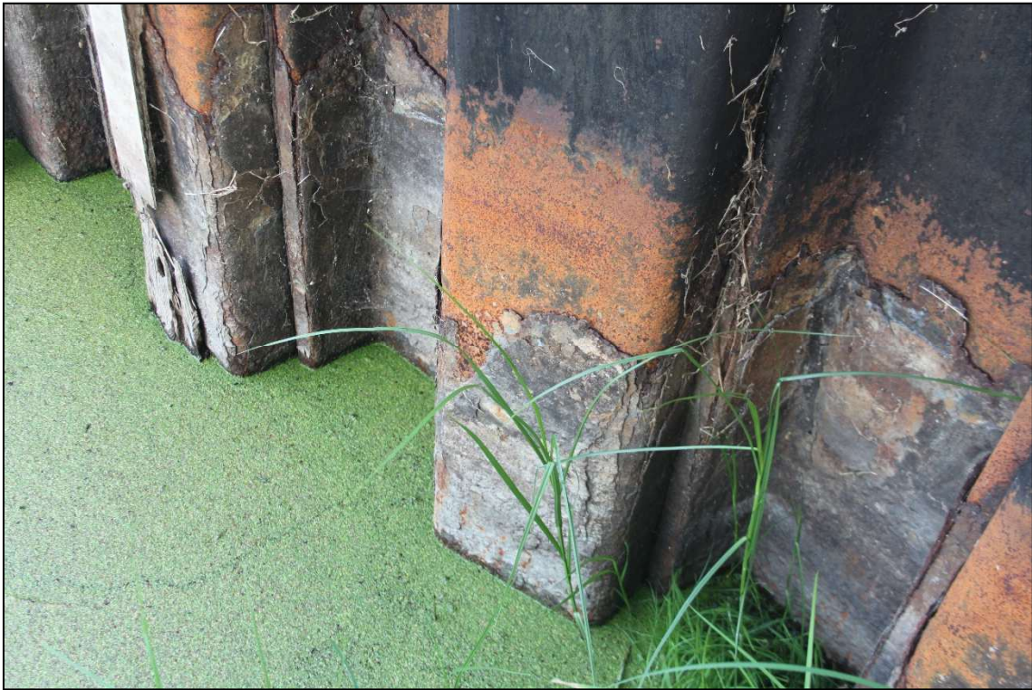
Abbildung 7: Korrosion Stahlspundwand, Oberwasser rechts (08/2018)
