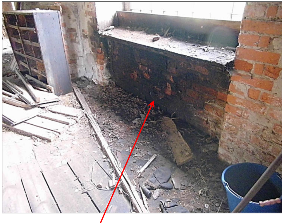
Bild 1: överschmutzter Teilbereich, westliche Innenwand Hauptgebäude; Probe 23059 - 2
