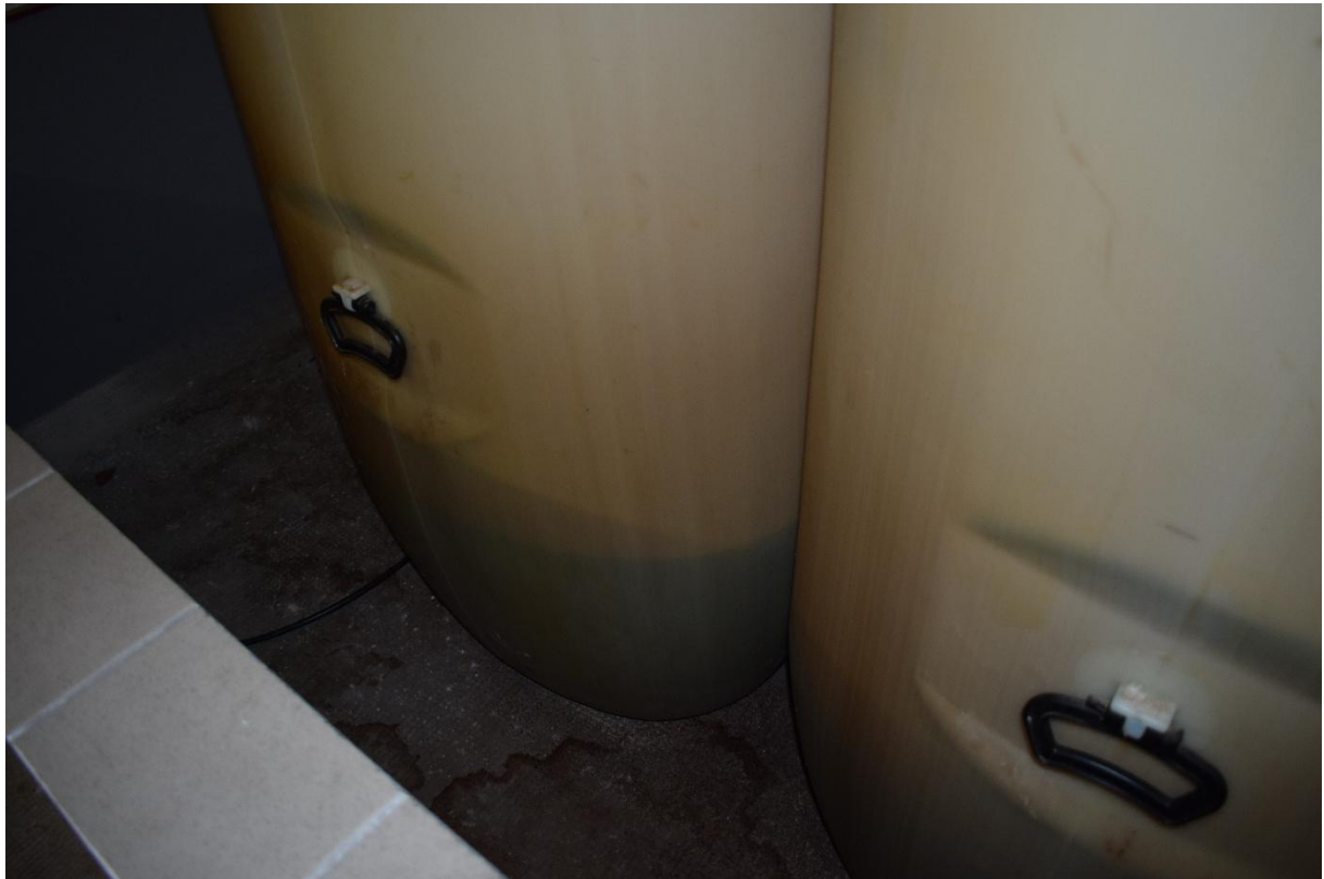
Bild 07: Innenansicht Wohngebäude – Öltanks
