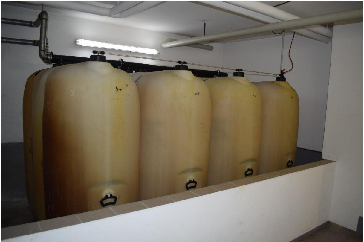
Bild 06: Innenansicht Wohngebäude - Öltanks
