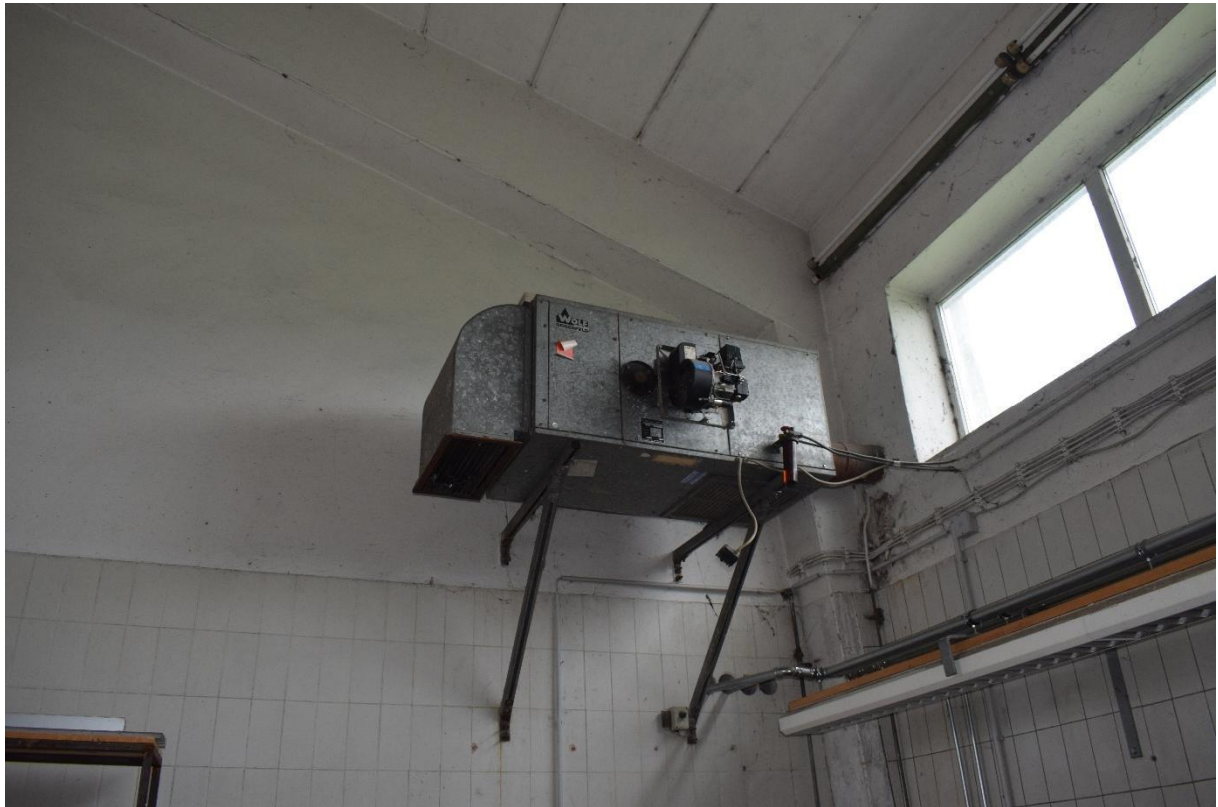
Bild 61: Ansicht Lagerhalle Flussmeisterstelle - Heizanlage
