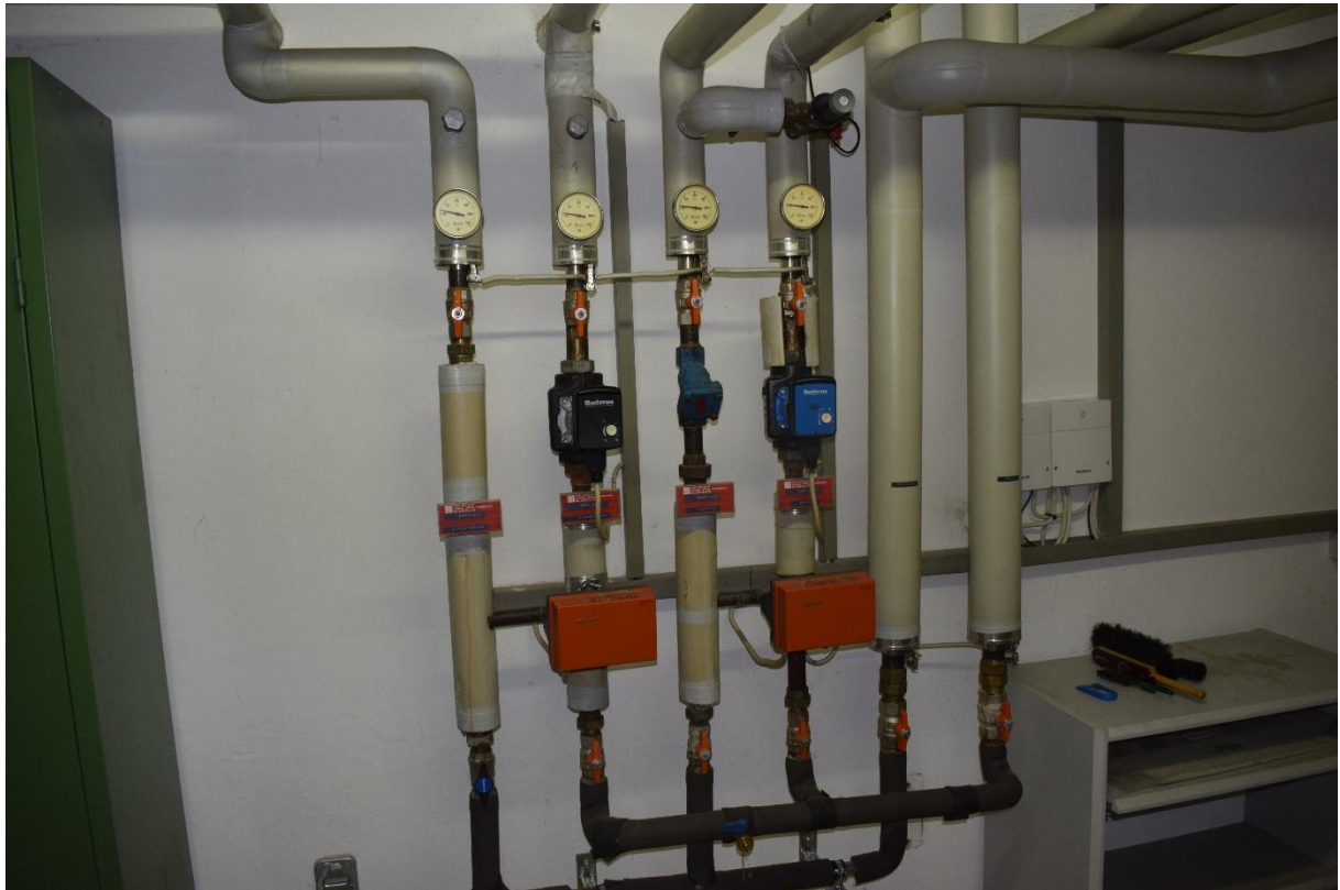
Bild 05: Innenansicht Wohngebäude - Heizungsanlage
