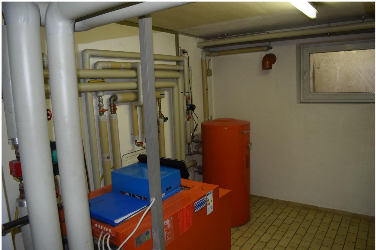
Bild 04: Innenansicht Wohngebäude - Heizungsanlage
