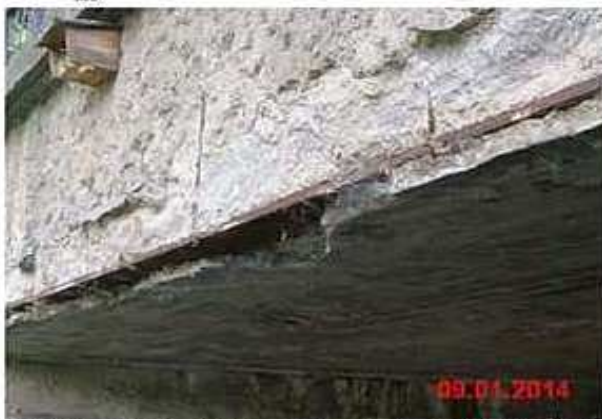
3649001 0 14E ZUSTAND DER LINKEN SEITENFLÄCHE
