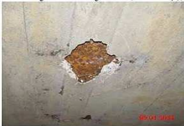
3649001 0 14E BETONZUSTAND UNTER DEN WALZTRÄGERN
