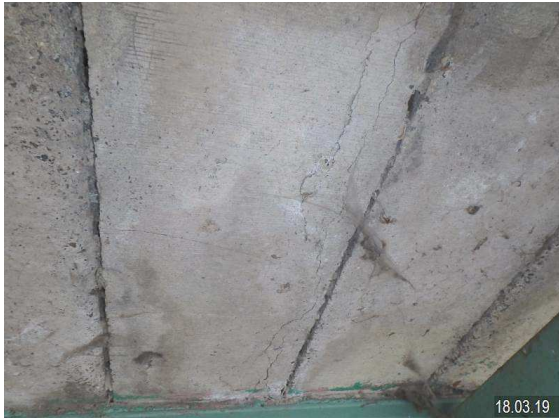
3446219_0_19E_FERTIGTEIL MIT RISS
