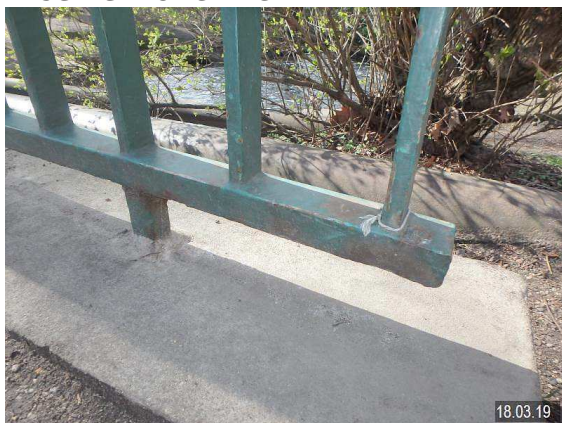
3446219_0_19E_GELÄNDER BESCHICHTUNG ABGEPLATZT
