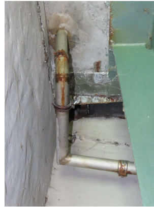
64_2023 ENTWÄSSERUNG IM BEREICH WIDERLAGER KORRODIERT
