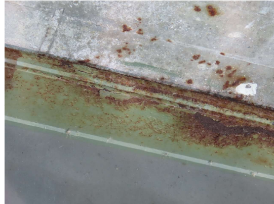
80_2023 FLANSCH OBEN AUßEN KORRODIERT
