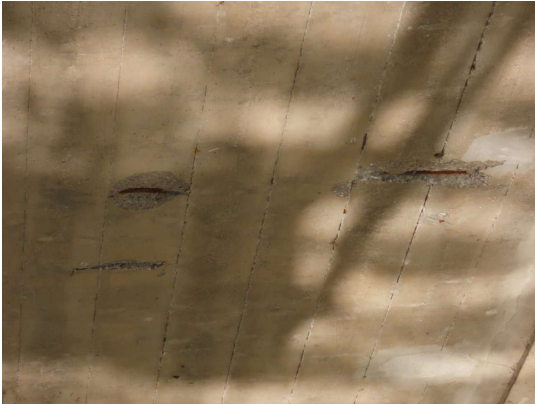
111_2023 KRAGARM BEIDSEITIG HS UND ABPLATZUNGEN
