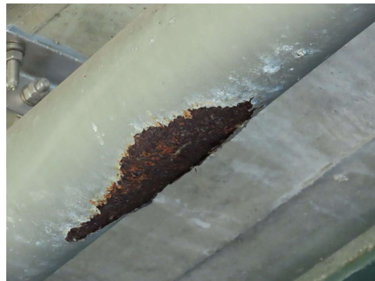
08_2023 EW-LEITUNG PUNKTUELL KORRODIERT
