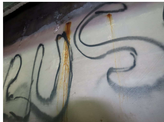
106_2023 WIDERLAGER HINTERE KAMMERWAND ROSTFAHNEN
