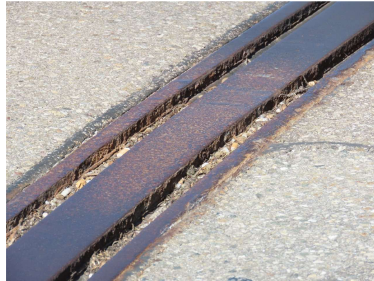
70_2023 ÜKO OBERSEITE KORRODIERT
