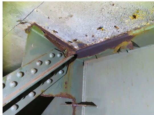
22_2023 ANSCHLUSS STREBE FLANSCH INNEN KORRODIERT
