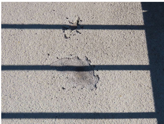
16_2023 KAPPENOBERSSEITE BESCHICHTUNG ABGELÖST
