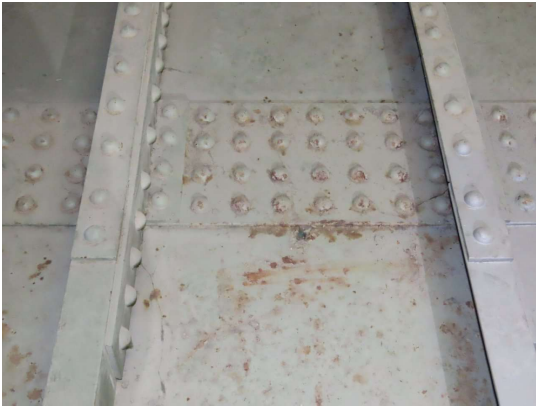
112_2023 BODENBLECH INNEN PUNKTUELL KORRODIERT
