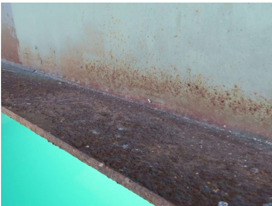
113_2023 FLANSCH UNTEN AUßEN KORRODIERT
