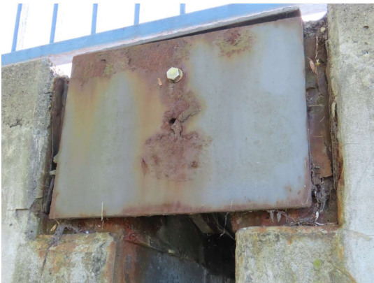
132_2023 ÜKO GESIMSABSCHLUSS KORRODIERT
