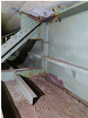
47_2023 AUSGEPRÄGTE KORROSION INNEN
