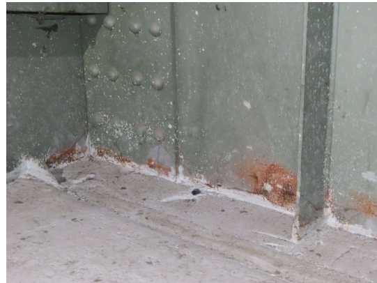
116_2023 HOHLKASTEN INNEN KORRODIERT
