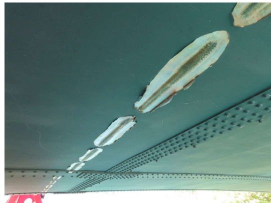
72_2023 BODENBLECH AUßEN BESCHICHTUNG ABGEPLATZT
