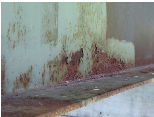
37_2023 BESCHICHTUNG INSTANDSETZUNG SCHADHAFT
