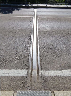
128_2023 BELAGSRISSE IM BEREICH DER ÜKO
