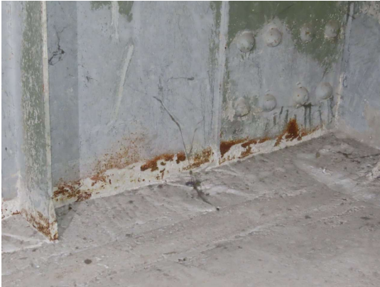
42_2023 QUERAUSSTEIFUNG INNEN FUßBEREICH KORRODIERT
