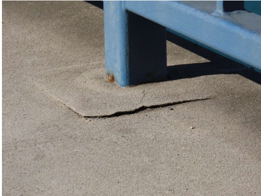
67_2023 PFOSTEN VERGUSS SCHADHAFT
