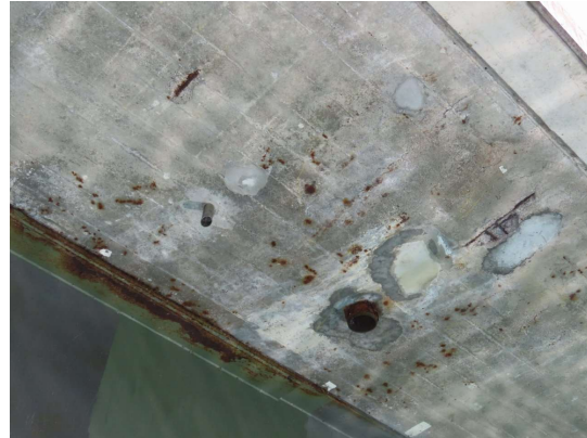
73_2023 KRAGARM OBERSTROM CHLORIDBELASTUNG
