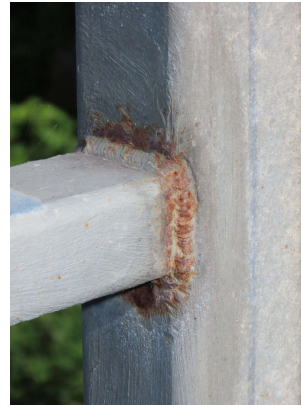
139_2023 GELÄNDER SCHWEIßNAHT KORRODEIRT
