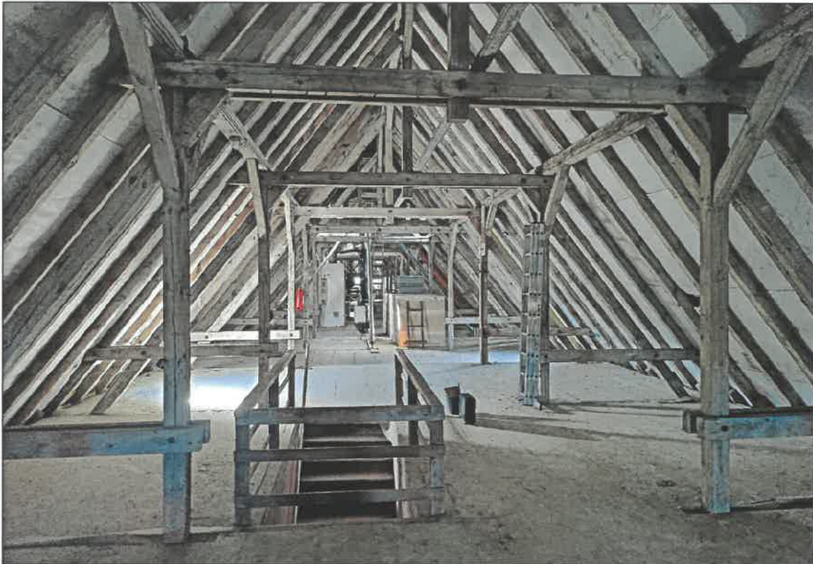
Bild 3: Dachboden, Zentralbereich – Dachstuhl mit biozidbelasteten Konstruktionshölzern und Fußboden mit Fußbodenplatten mit Steinwolle-Dämmung unter Fermacell (Detailaufnahme s. Bild 4).
