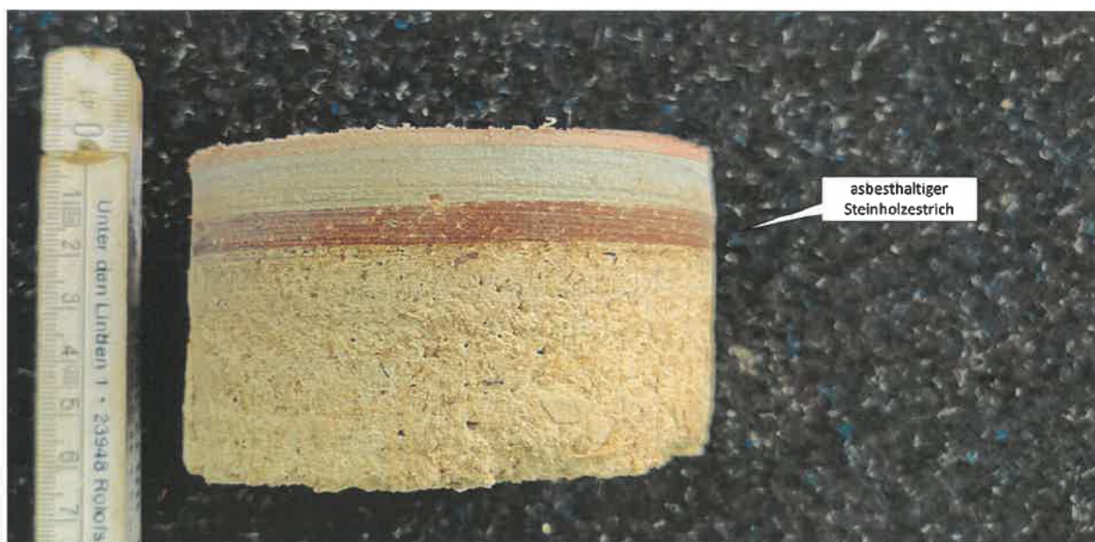
Bild 20: 1. OG, Flur – Kernbohrung 23-069/19 zeigt Fußbodenaufbau mit asbesthaltigem Steinholzestrich.
