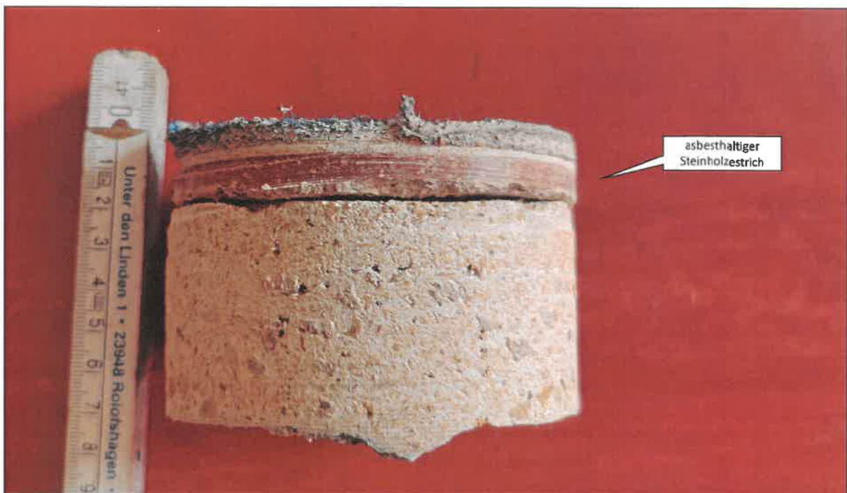
Bild 18: 2. OG, R 214, Bibliothek – Kernbohrung 23-069/12 zeigt Fußbodenaufbau mit asbesthaltigem Steinholzestrich.
