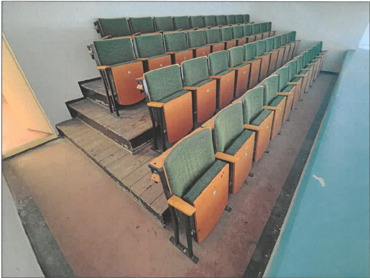
Bild 19: Dachgeschoss, R 327, Empore – Fußboden mit rotbraunem, asbesthaltigen Steinholzestrich.
