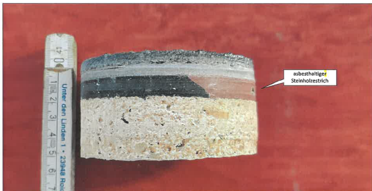
Bild 16: 2. OG, Raum 205 – Kernbohrung 23-069/10 zeigt Fußbodenaufbau mit asbesthaltigem Steinholzestrich.
