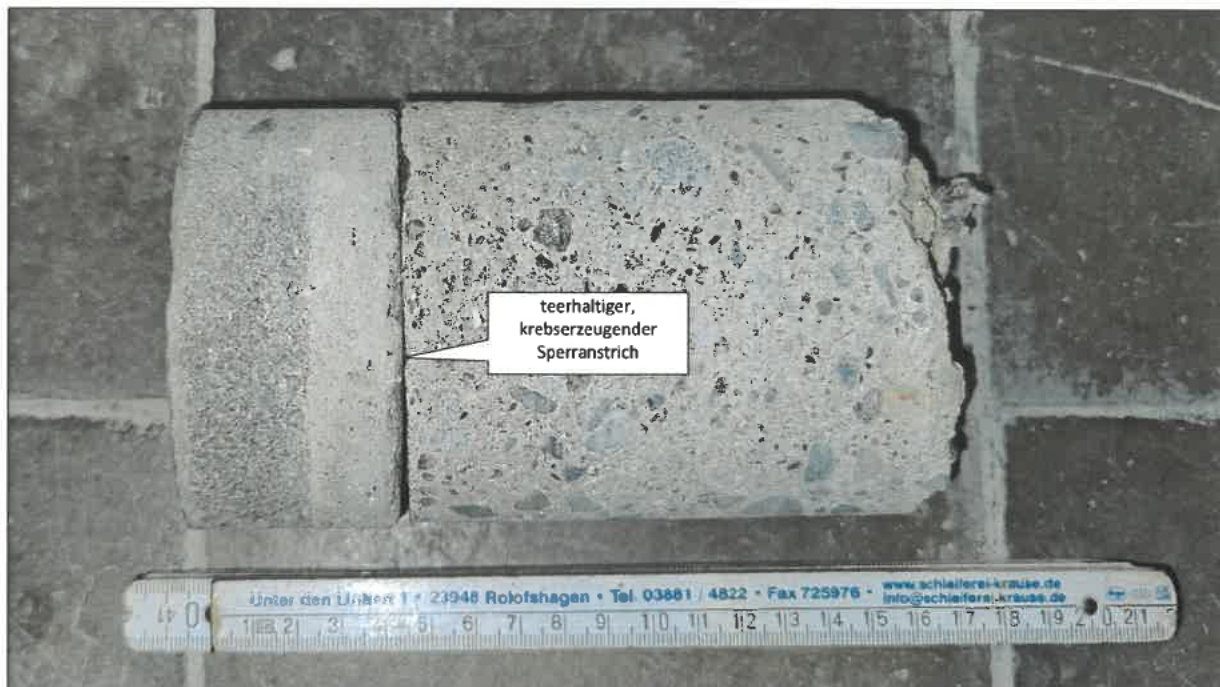
Bild 23: KG, Flur K 27 – Kernbohrung 23-069/21 zeigt Fußbodenaufbau mit Fliese, Mörtel, teerhaltigem, krebserzeugendem Sperranstrich und Rohbeton.
