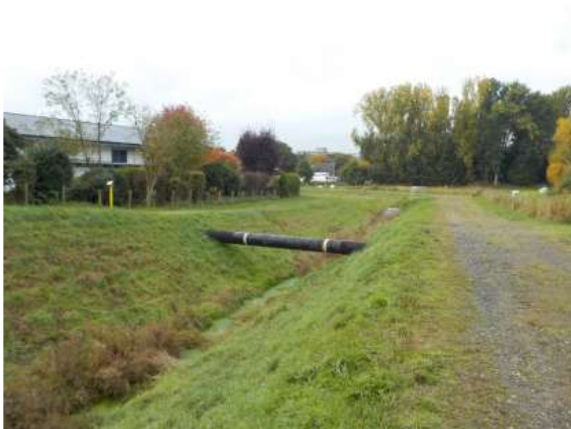
Bild 2 Gasleitung DN 500 der Fa. Thyssen Gas
