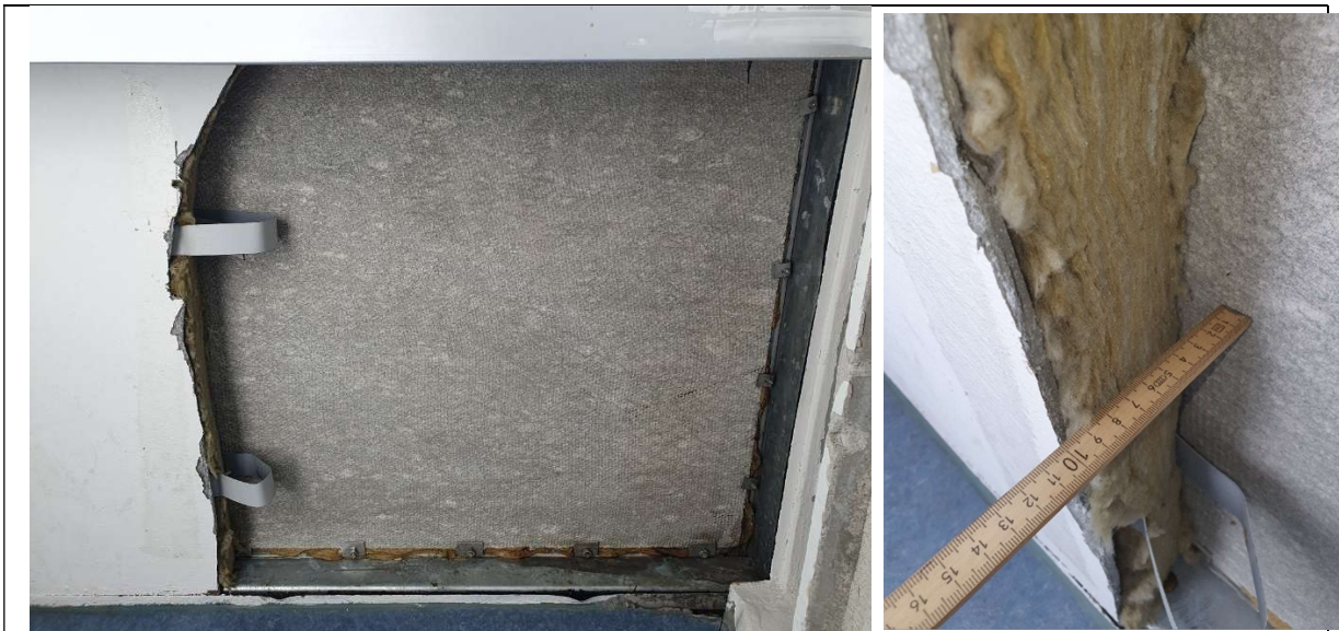
Innere AZ-Platte geöffnet, KMF + äußere AZ-Platte sichtbar
