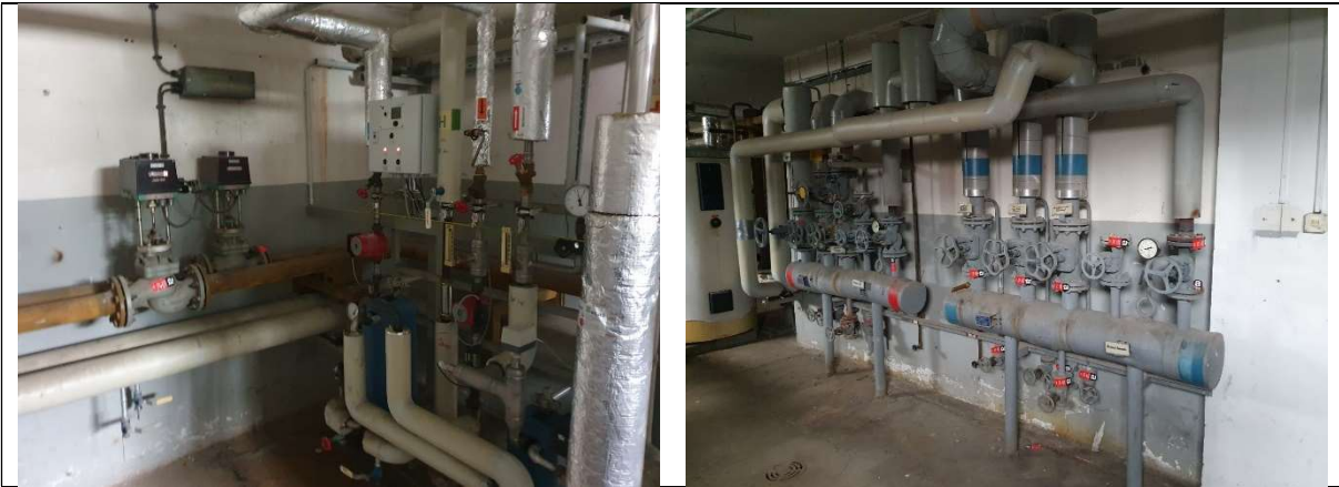
Heizraum mit asbesthaltigen Flanschdichtungen und KMF-Rohrdämmung
