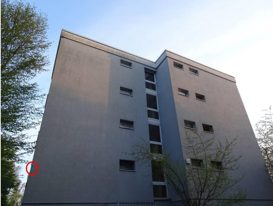
Abb. 7: Einflugöffnungen eines Gebäudebrüters in der Fassade Buckower Damm Nr. 91 (roter Kreis)
