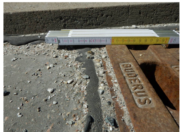
1839511_1_2018H_BRÜCKENABLAUF ZU HOCH
