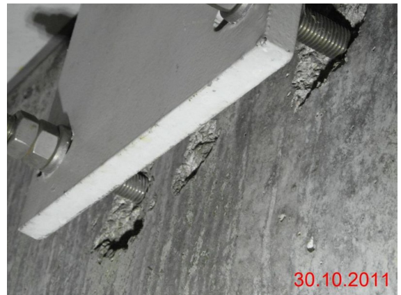
1839511_1_2011_H_BETONABPLATZUNGEN AM GESIMS
