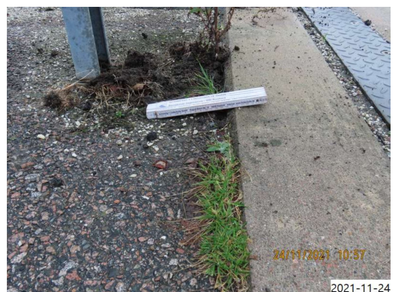
1839511_1_21E_BW ENDE GEH-RADWEG RE ASPHALT ABGESACKT
