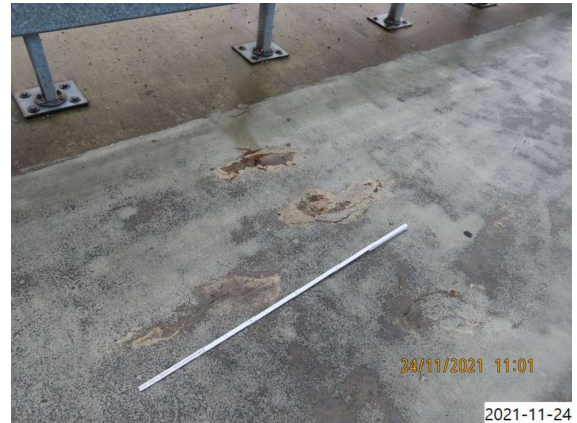
1839511_1_21E_KAPPEN GERISSEN UND HOHLSTELLEN
