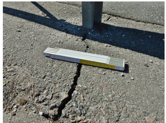
1839511_1_2018H_HINTER DEM BW ASPHALTSTREIFEN UNTER EDSP
