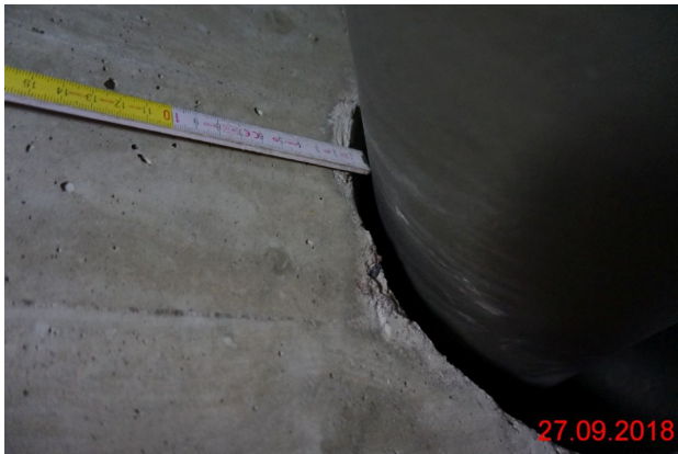
1645502_0_2018H2_QUERTRÄGER ROHRDURCHFÜHRUNG ABSTAND ZU GERING
