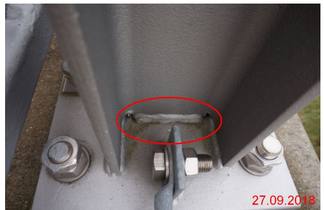
1645502_0_2018H2_BERÜHRUNGSSCHUTZ SCHWEIßNAHT UNVOLLSTÄNDIG
