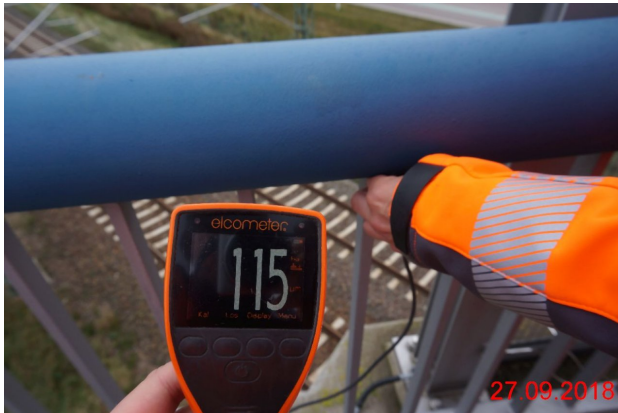
1645502_0_2018H2_GELÄNDER SCHICHTDICKE ZU GERING
