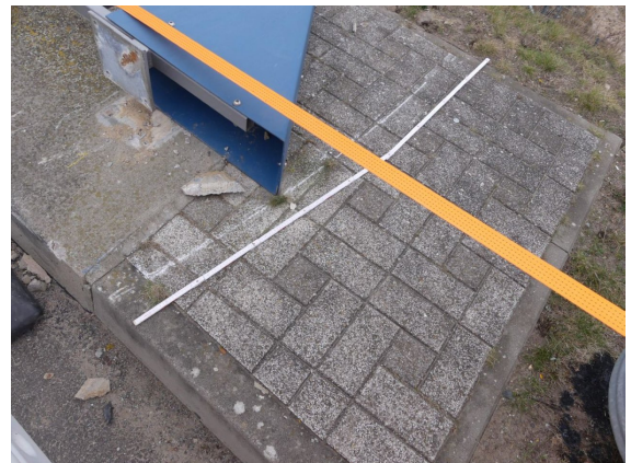
1645502_0_2024S1_PFLASTERUNG OBERFLÄCHLICH BESCHÄDIGT
