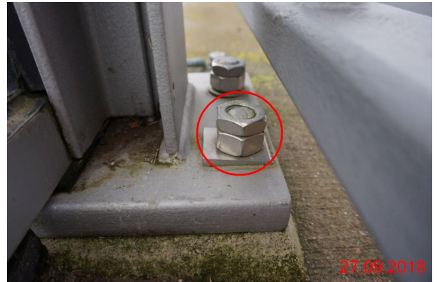
1645502_0_2018H2_BERÜHRUNGSSCHUTZ MUTTER NICHT AUSREICHEND GESICHERT
