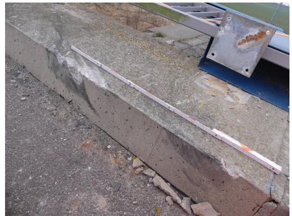
1645502_0_2024S1_KAPPE VR ABPLATZUNGEN BETONoberfläche
