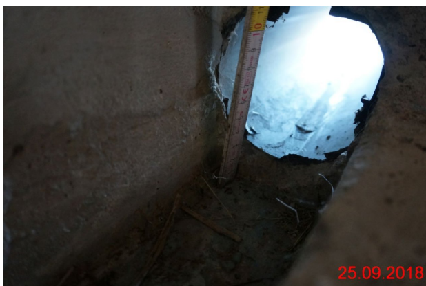
1645502_0_2018H2_AUFLAGERBANK ENTWÄSSERUNGSRINNE NICHT DURCHGEHEND
