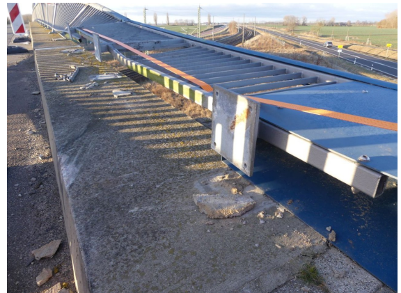
1645502_0_2024S1_GEL ANKER ABGERISSEN
