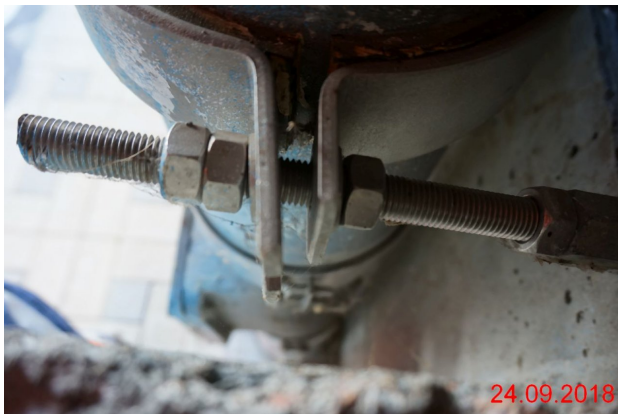
1645502_0_2018H2_FALLLEITUNG GEWINDESTANGEN SCHIEF
