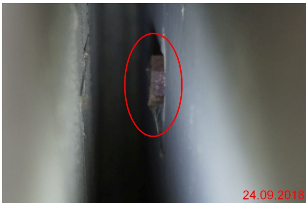
1645502_0_2018H2_SEITLICHE KAMMERWAND HÜLSE FÜR SCHALUNGSANKER ANGEROSTET
