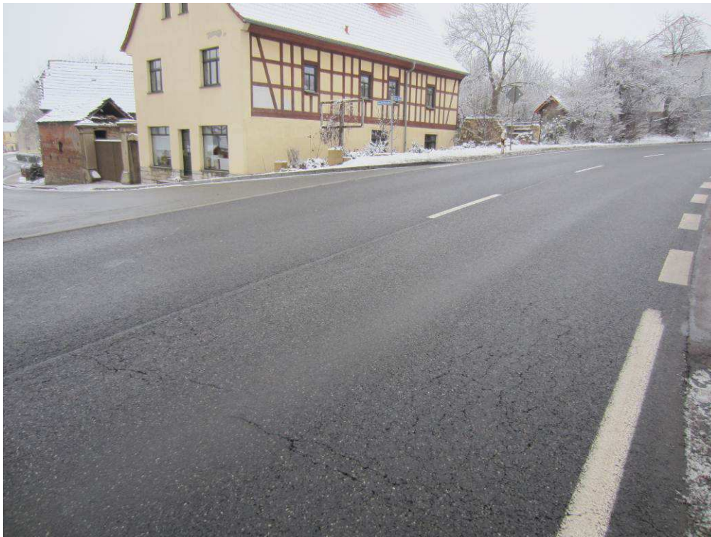
Bild 1: Fahrbahnzustand im Bereich Messpunkt BS 1; Querrisse, Einzelrisse, beginnende Netzrisse, Spurrinnenbildung, Ausmagerungen mit Kornausbrüchen
