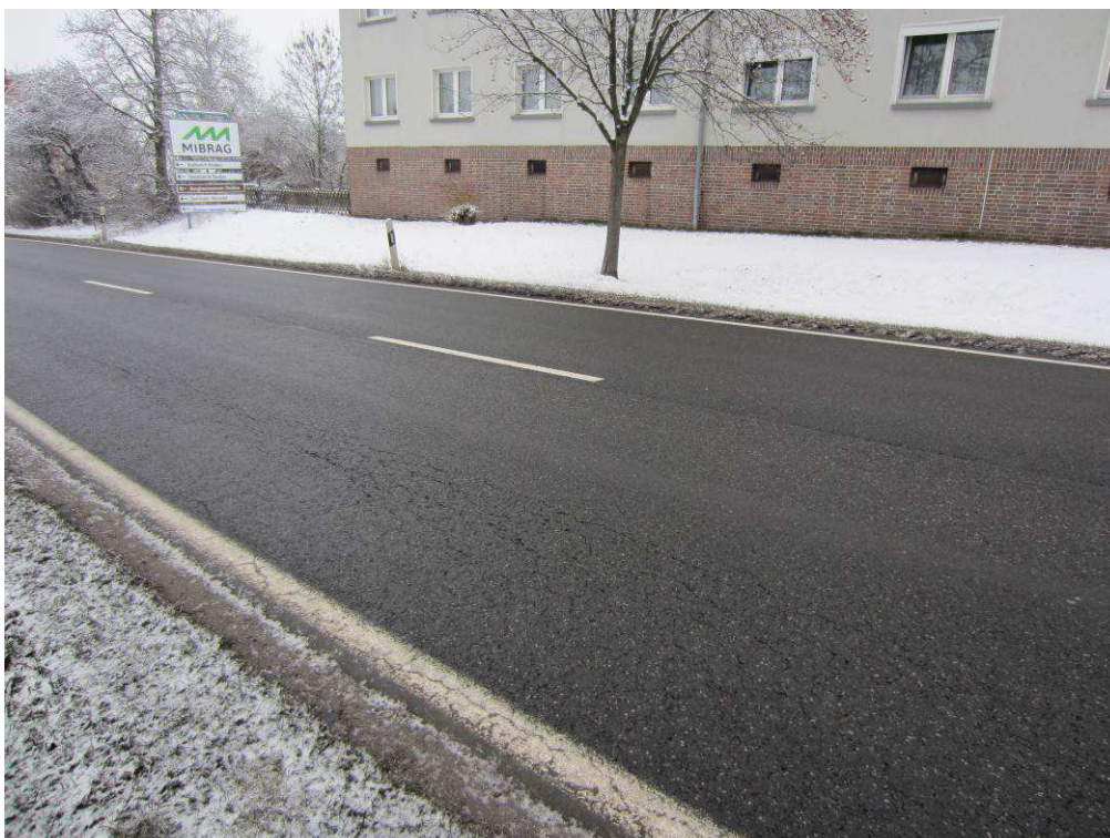
Bild 2: Fahrbahnzustand am Messpunkt BS 1; Einzelrisse, beginnende Netzrisse, Spurrinnen, Ausmagerungen mit Kornausbrüchen
