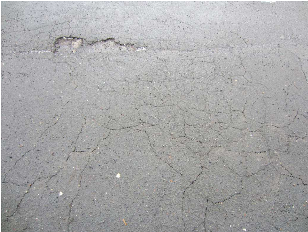
Bild 3: Fahrbahnzustand im Bereich Messpunkt BS 2; Einzelrisse, Netzrissbildungen, Ausmagerungen mit Kornausbrüchen, Aufbruch der Asphaltdeckschicht
