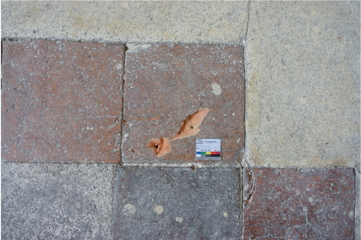
Abbildung 18: Raum 2.06. Fehlstelle Terrakotta.
