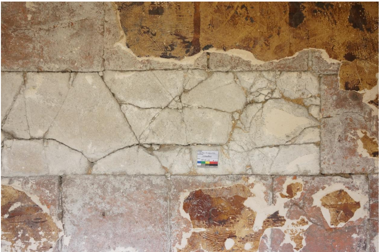
Abbildung 11: Raum 2.06. Stark gebrochenes Estrichfeld in Fensternische = erneuern.
