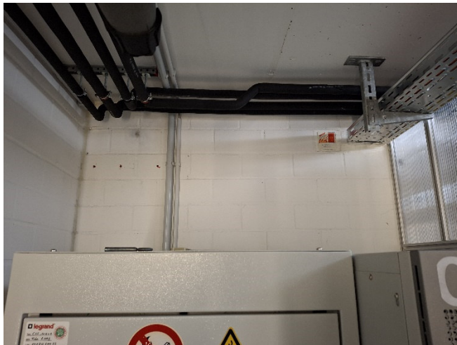
Einbauten über der USV
