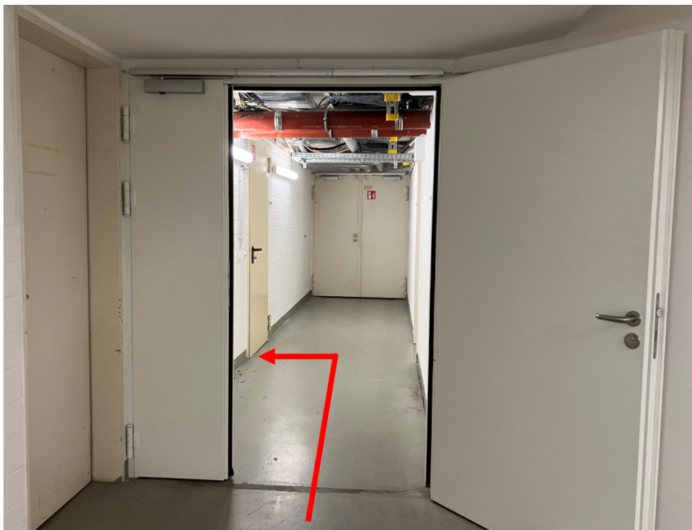
Eingang Serverraum (Standort USV)
