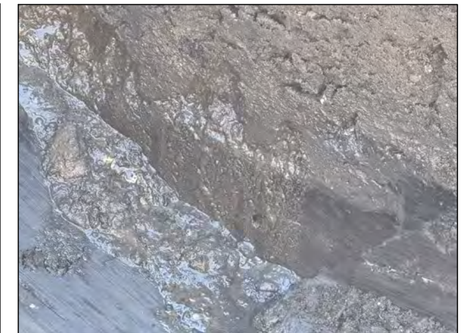
Abb. 2: Sickerwasseraustritt auf der OK Auehm
