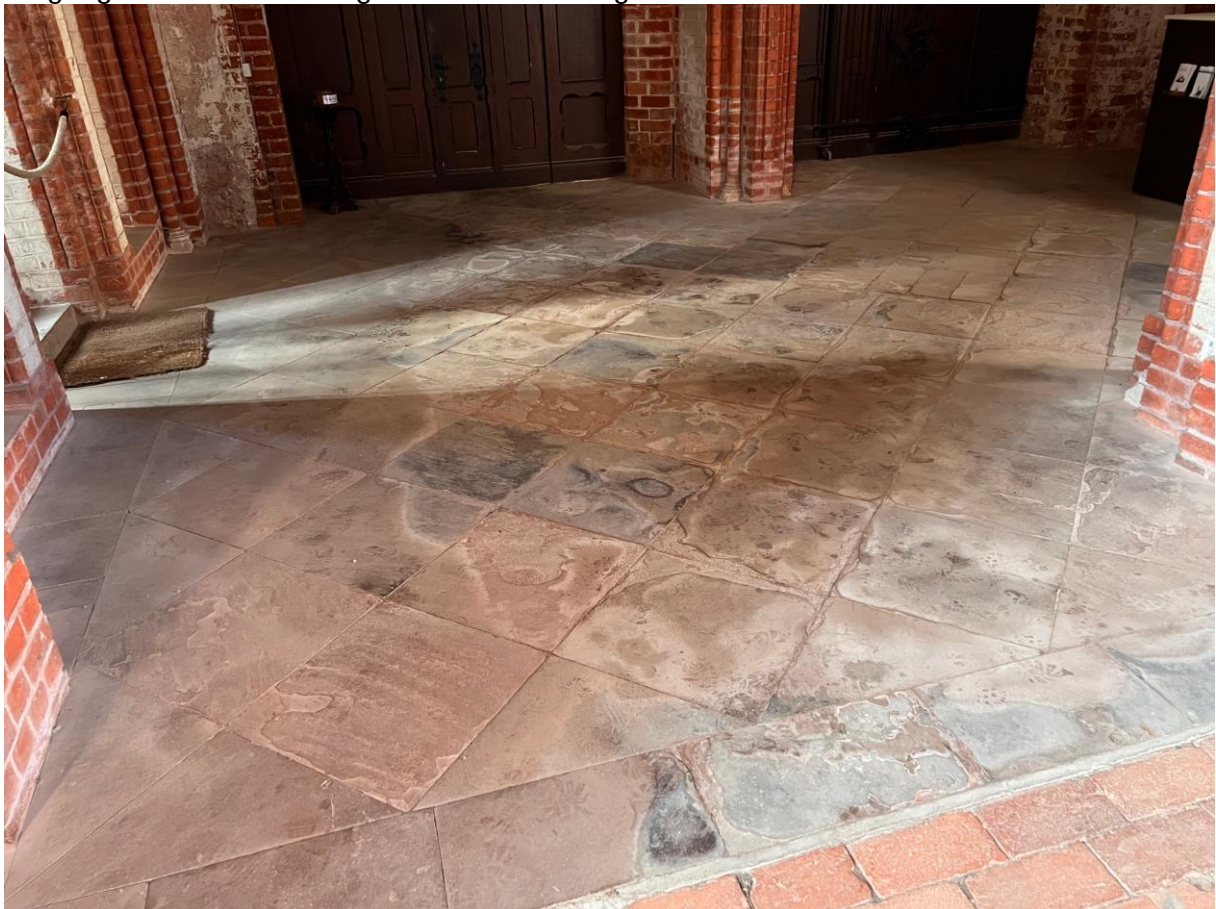
Bodenbelag in Eingangshalle unter Orgel – Salzbelastung
