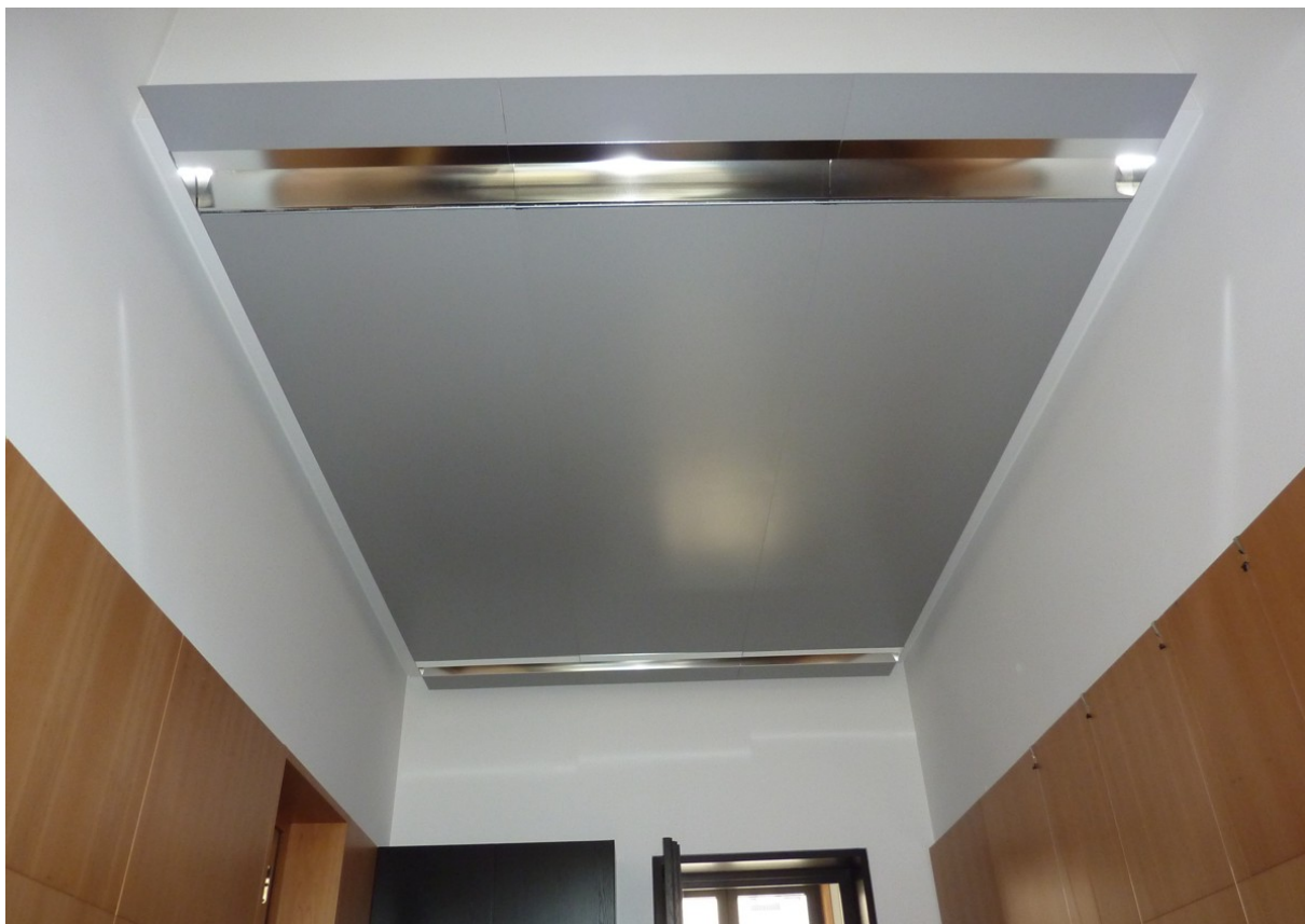
Abb. 1 Büroraum, Decke mit Metalldeckenpaneelen glatt/geschlossen und Beleuchtung
