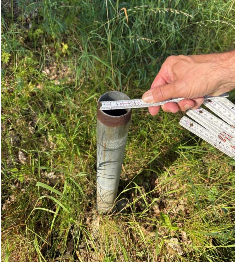
Bild 4 – defekte Grundwassermessstelle B2 a
