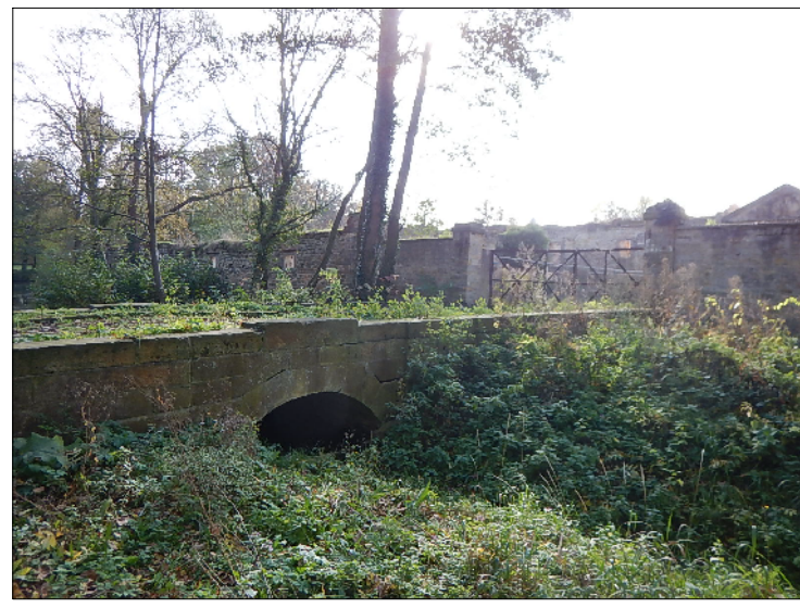
Sanierung der nördlichen Steinbrücke mit Geländerrichtung Größe ca. 7 m x 22 m für Schwerlasttransport
